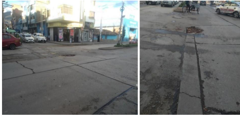
Figura 31: Fallas superficiales en el pavimento rígido
