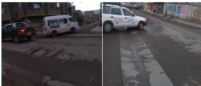
Figura 33: Fallas superficiales en el pavimento flexible
