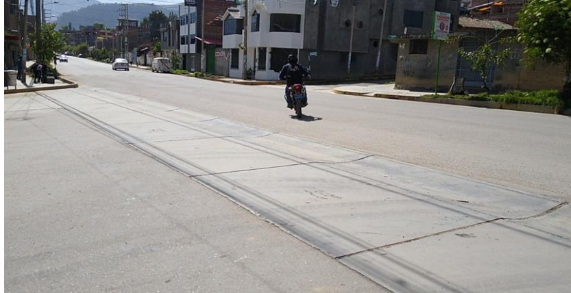
Figura 37: Fallas superficiales en el pavimento flexible
