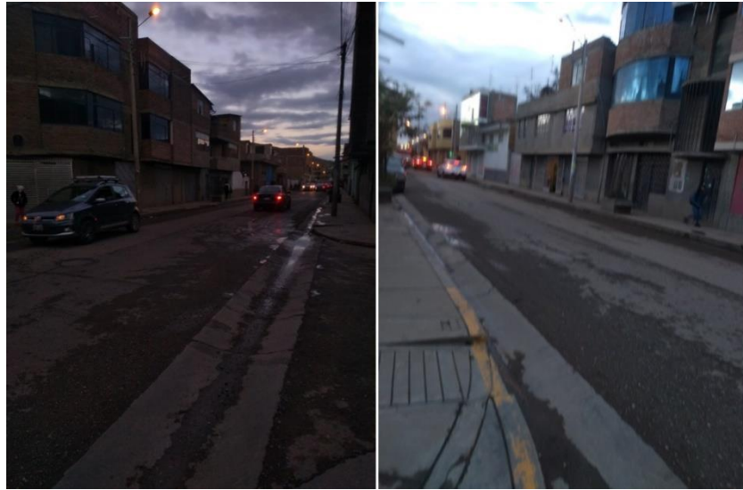
Figura 35: Fallas superficiales en el pavimento flexible
