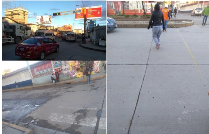
Figura 39: Fallas superficiales en el pavimento rígido
