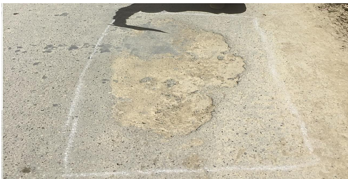
Figura 1: Pavimento con presencia de fallas por pérdida de adherencia
