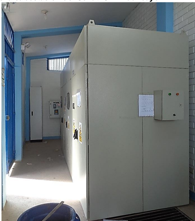
Anexo 13. Interior de la subestación del Senati CFP Huancayo
