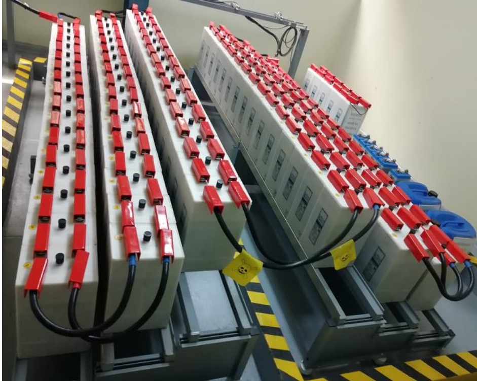
Figura 10: Nuevo banco de baterías 125 Vdc con capacidad de 560 AH Fuente: elaboración propia
