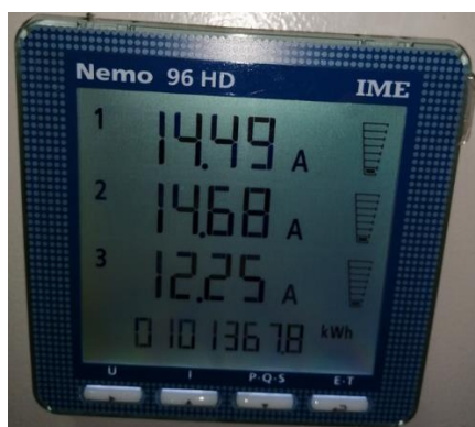
Figura 20: Datos de corriente en el controlador MCU 2500 Fuente: elaboración propia
