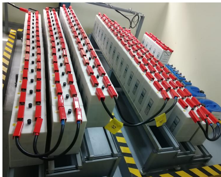
Figura 4: Nuevo banco de baterías 125 Vdc con capacidad de 560 AH Fuente: elaboración propia
