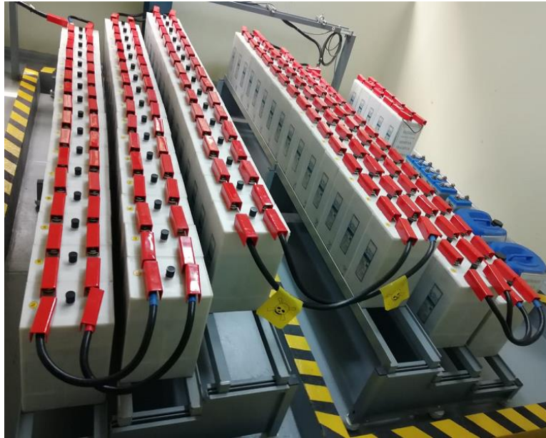
Figura 18: Conexión del nuevo banco de baterías 125 Vdc con capacidad de 560 AH. Fuente: elaboración propia
