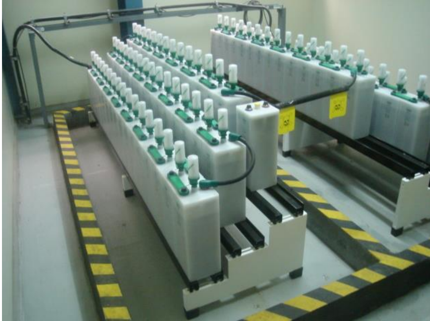
Figura 9: Banco de baterías antiguo Fuente: elaboración propia
