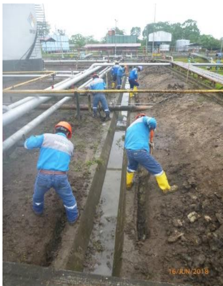
Figura 11. Excavación para sardinel sumergido. Tomado de “Impermeabilización de Áreas Estancas Lote 8”, por D. Manrique, 2019.
