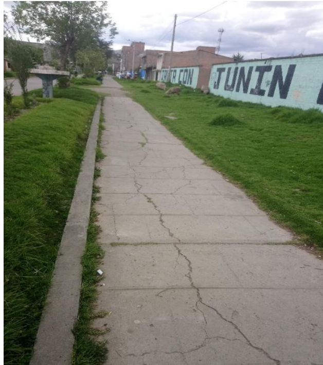
Fotografía 1. Senda en mal estado físico, alameda.
