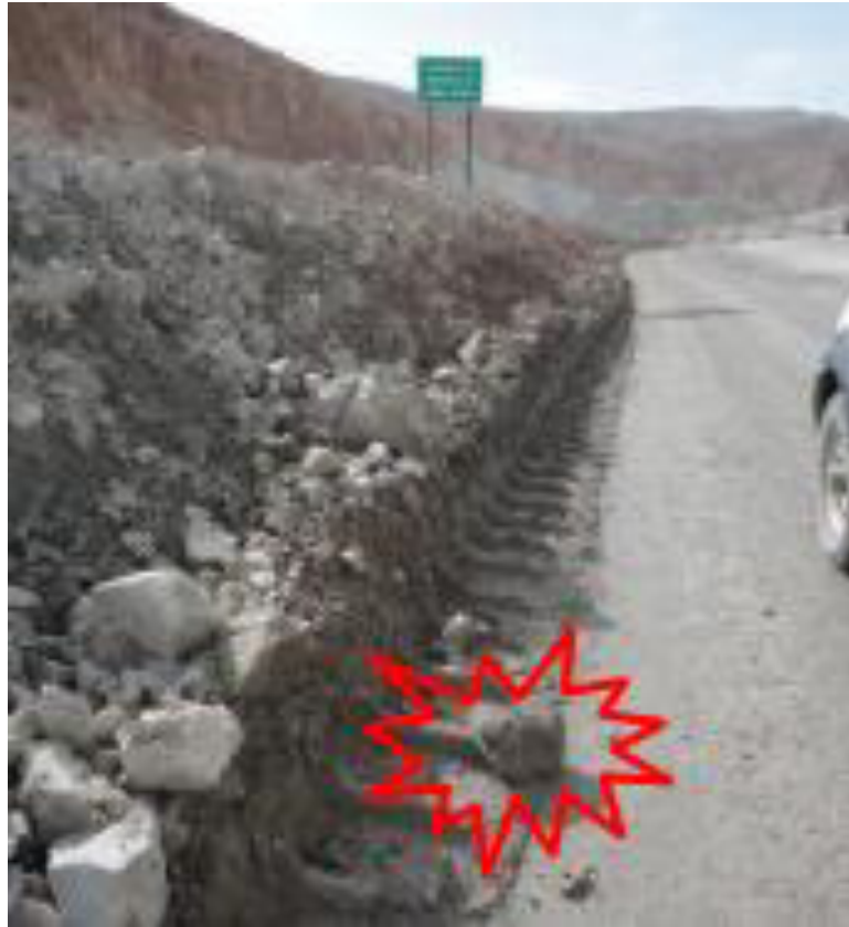
Figura 29. Desprendimiento de rocas en los accesos de la mina
