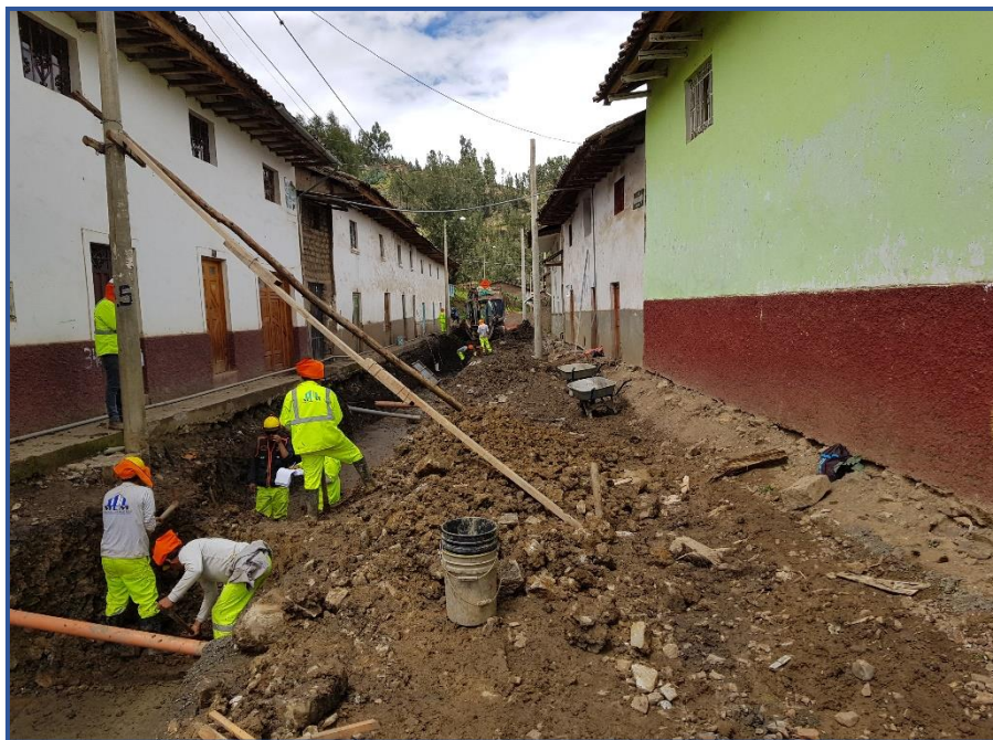
Figura 31. Falta de frente de trabajo para esta actividad.
