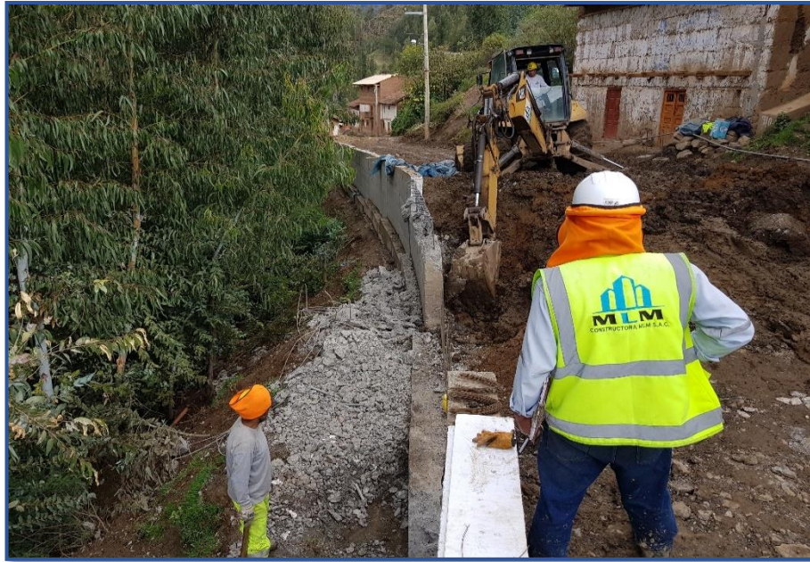
Figura 40. Sobrecostos por demolición de muro de contención
