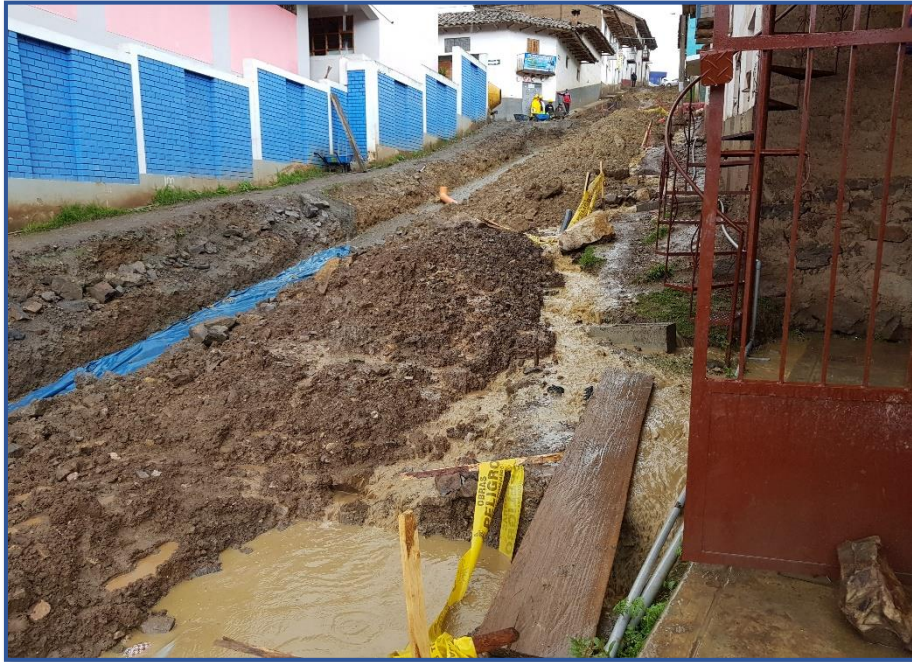
Figura 33. Retraso del entregable alcantarillado sanitario por lluvias torrenciales.
