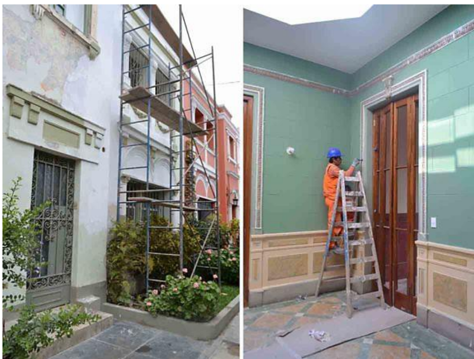
Figura 13: PROCESO DE TRANSFORMACIÓN DE UN INMUEBLE DESPUÉS DE LA APLICACIÓN DE LOS DAET
