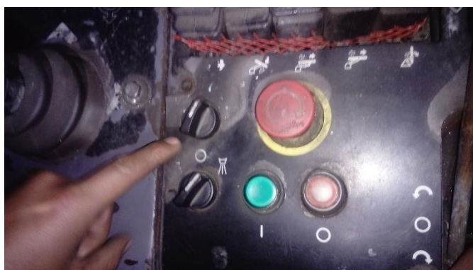
Figura 40. Selector de brocas presenta fallas (no activa)
