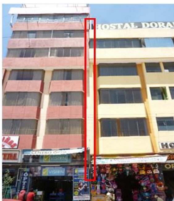
Figura 5: Inexistencia de juntas de separación sísmica entre las edificaciones.
