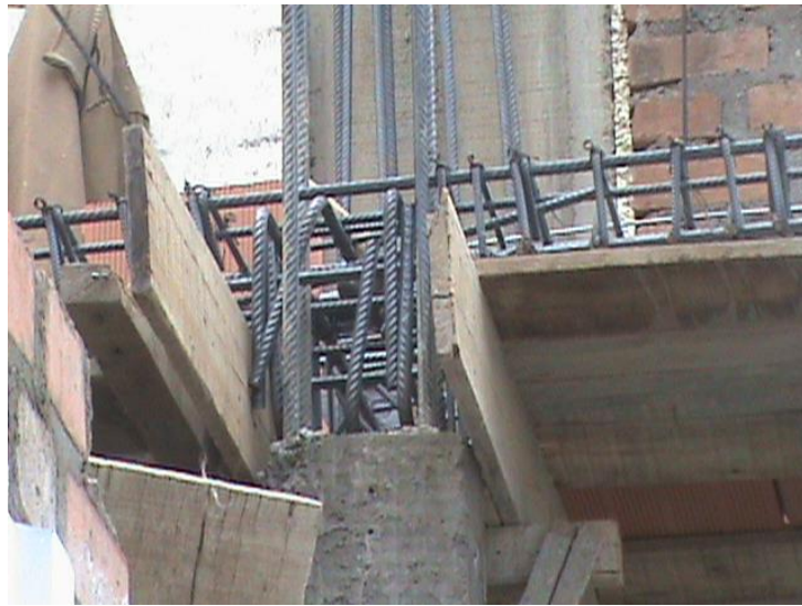
Figura 2: El refuerzo de la viga esta fuera del núcleo de la columna
