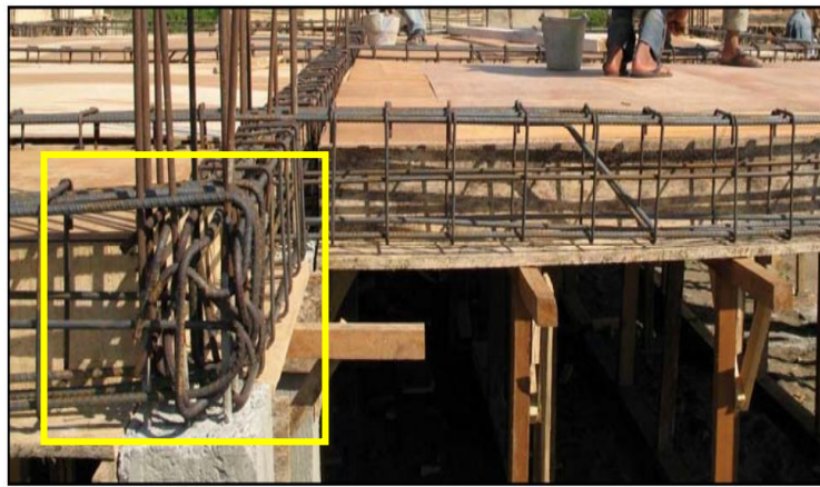
Figura 11: Congestionamiento del refuerzo en el nudo entre la viga y la columna – Indonesia, 2004
