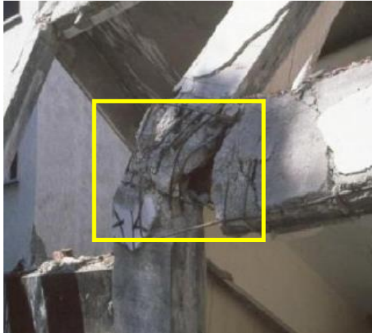
Figura 13: Falla en nudos viga columna, por ausencia de estribos
