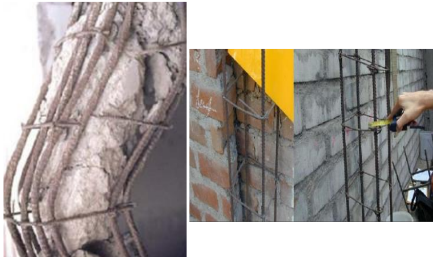
Figura 12: Pandeo del acero de la columna por estribos abiertos
