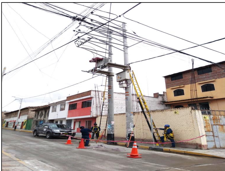
Figura 4: Servicio del área de operación y mantenimiento.
