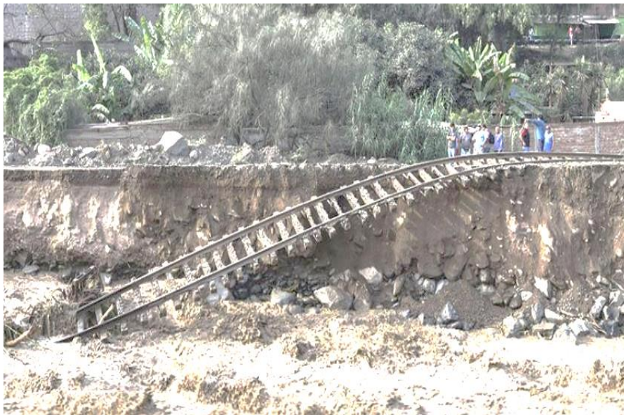
Figura 2: Daños generados por el fenómeno El Niño Costero 2017- PK 45.000
