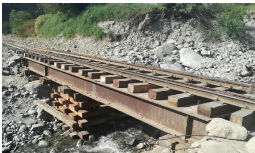
Figura 16: Daños en el PK 89+600 ML
