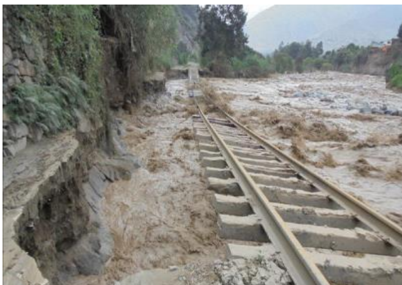
Figura 14: Daños en el PK 50
