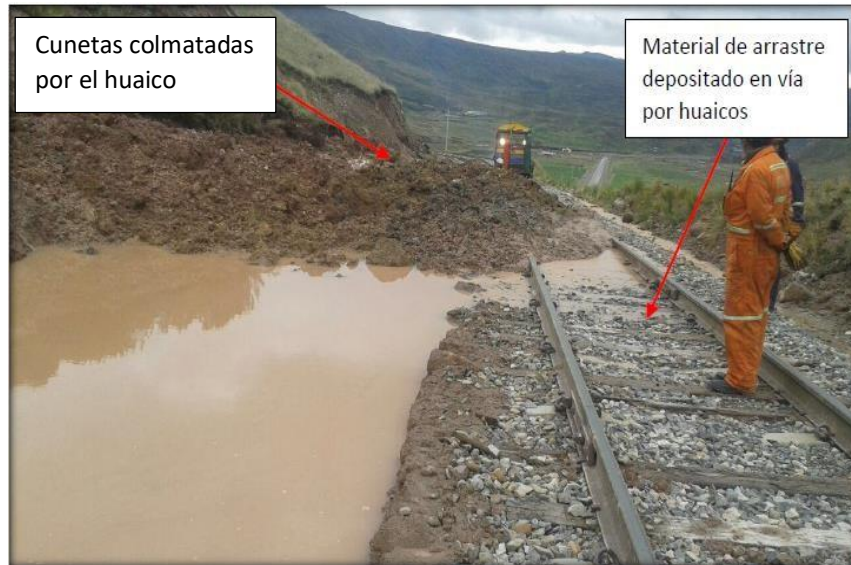
Figura 19: Daños entre los PK 188 al PK 294
