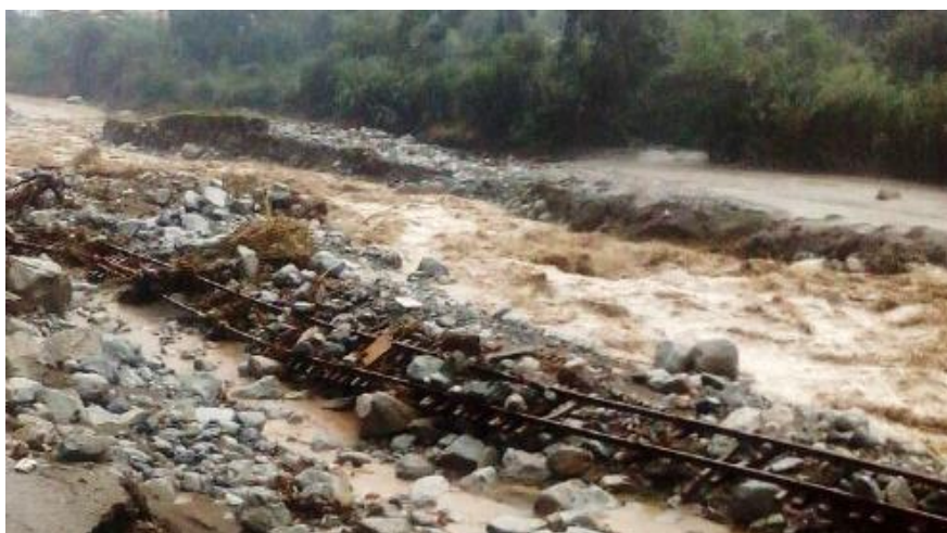
Figura 15: Daños en el PK 62+700 ML
