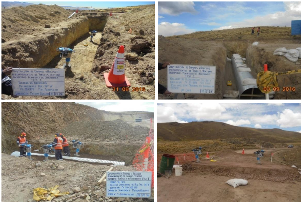
Figura N°74: Control de calidad en terreno de fundación y relleno estructural en alcantarillas
