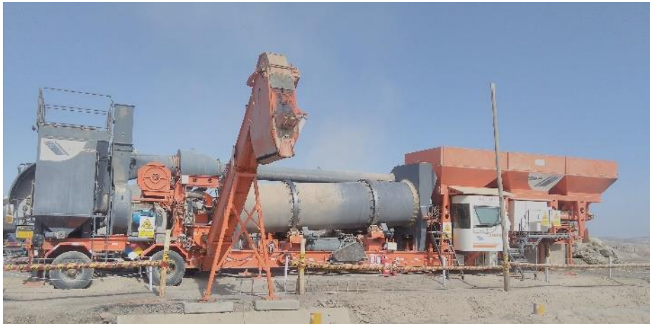
Figura N°38: Planta de asfalto del GRT
