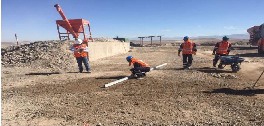
Figura N°37: Compactación y control de la nivelación del área para instalación de la planta de asfalto.
