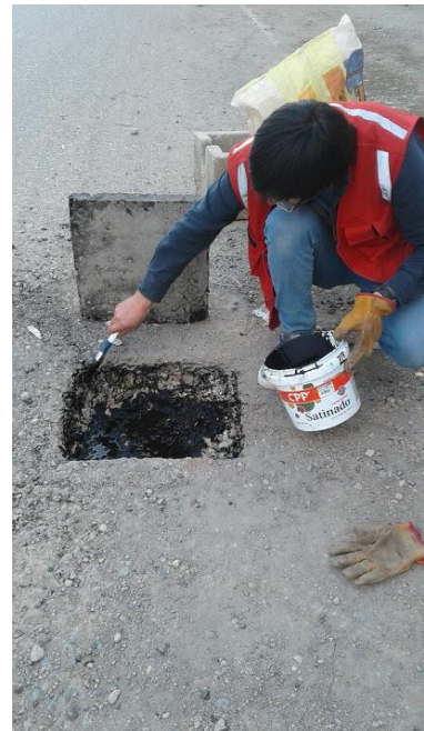
Fotografía N° 18 Zona de extracción parchada
