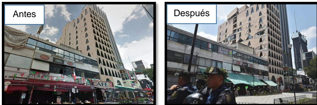
Figura 3 Edificio Acrópolis antes y después del sismo
