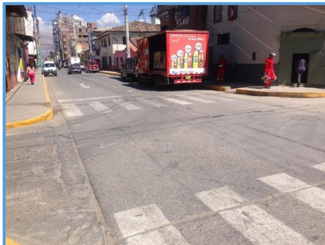
Fotografía 19. Existe señalización peatonal borrosa Fuente: Elaboración propia
