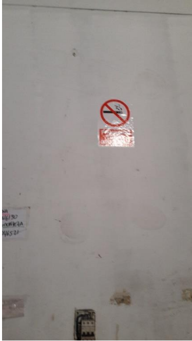
Fotografía 29: Señalizaciones en el área de producción 2
