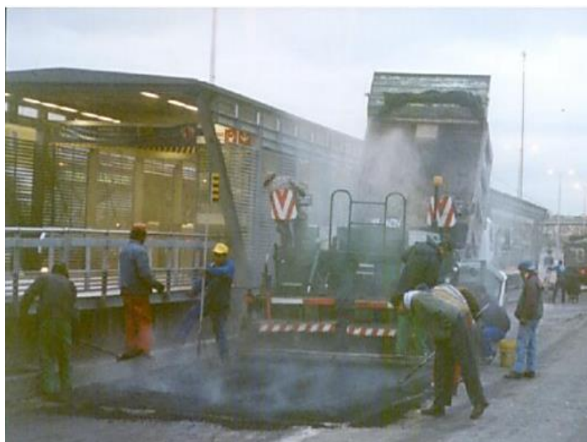
Figura 2. Extensión y compactación de base de alto módulo, Calle 80 con Avenida 68 – Transmilenio (Colombia).
