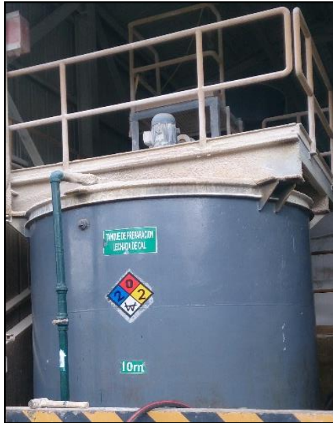
Figura 01: Tanque de preparación
