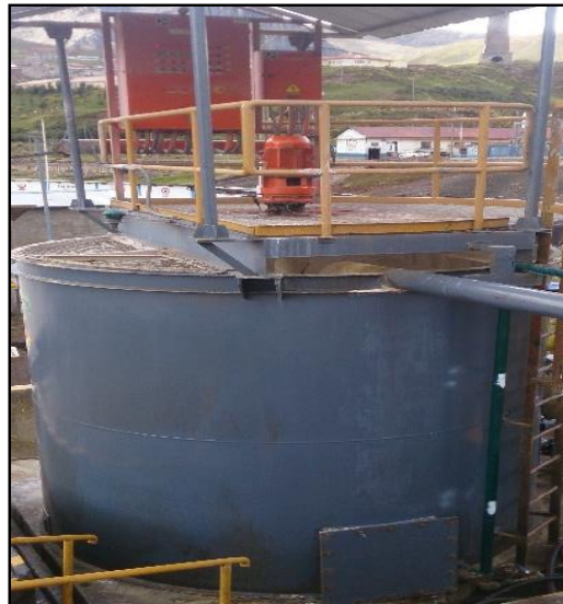
Figura 02: Tanque de dosificación
