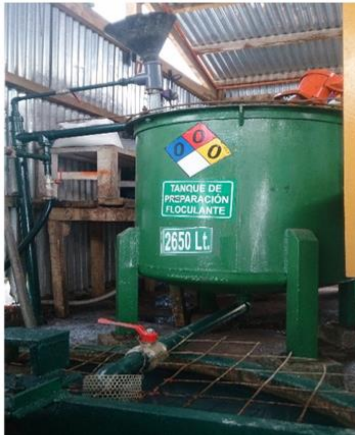
Figura 03: Tanque de preparación del floculante
