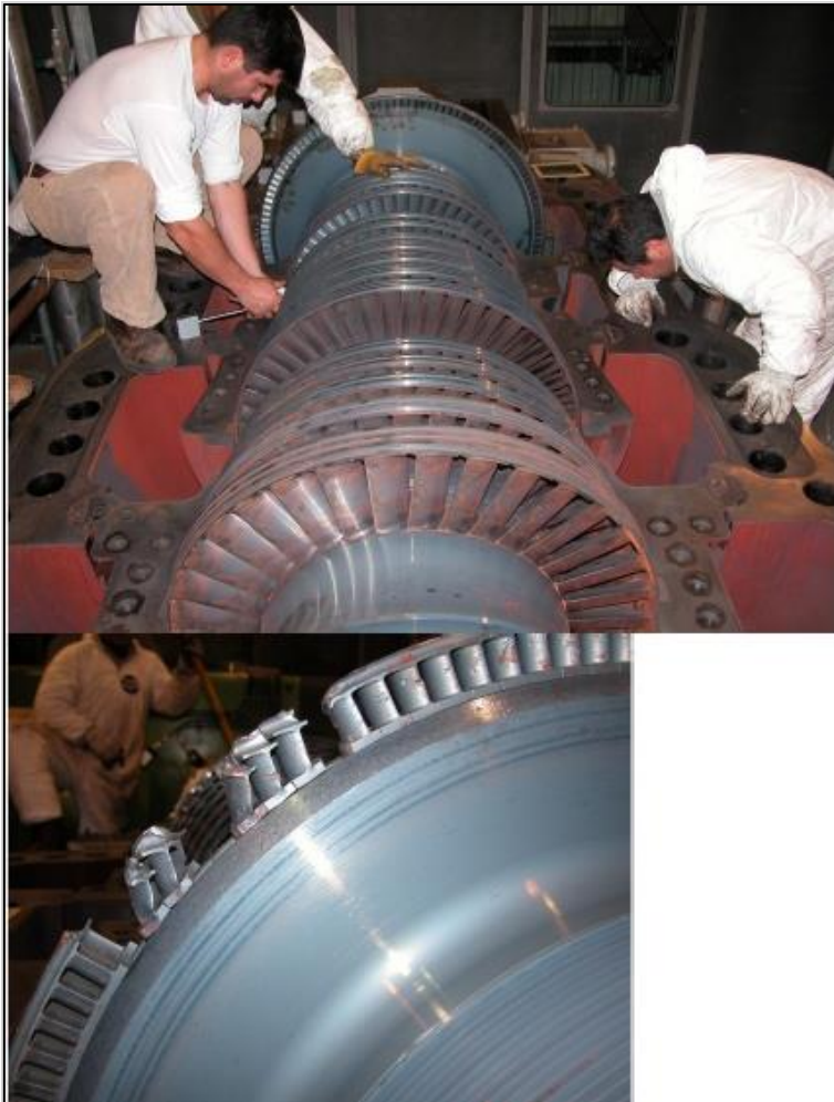
Figura 2. Falla de desgaste del turbogenerador en la Industria celulosa.
