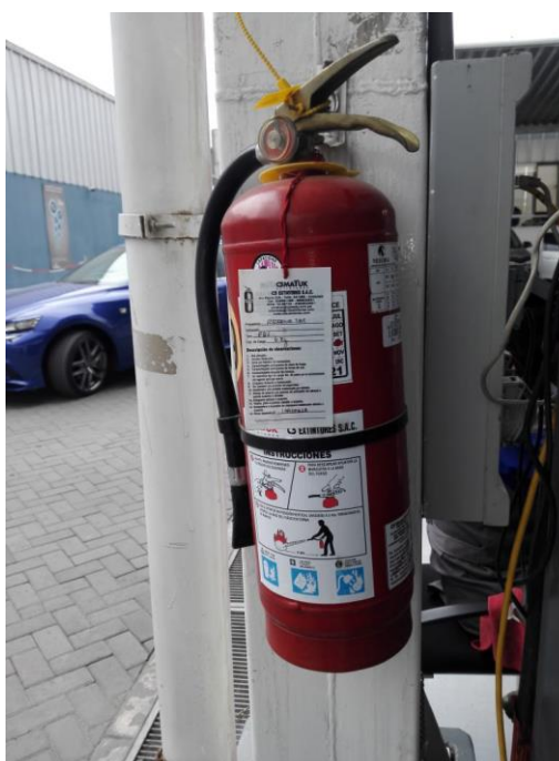
Panel Fotográfico 3: Estado actual de extintores.
