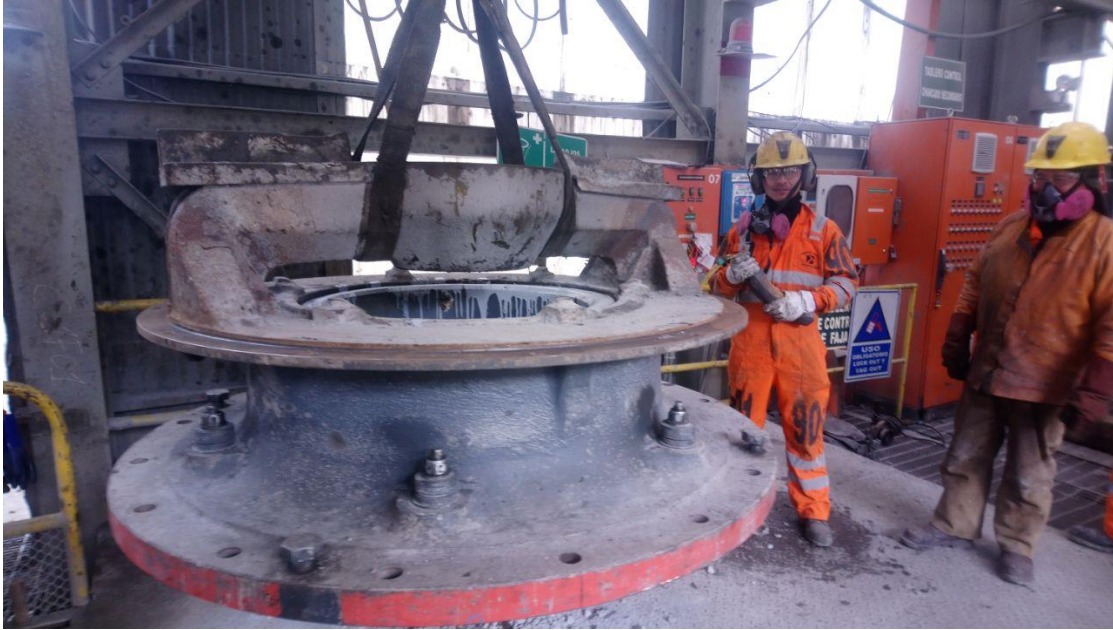
FOTO 3: VERIFICACIÓN DEL CIRCUITO DE MOLIENDA
