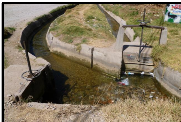
Figura 14. Compuertas de Distribución del Agua en Mal Estado con Arena en el fondo Nota. Fuente Elaboración Propia.
