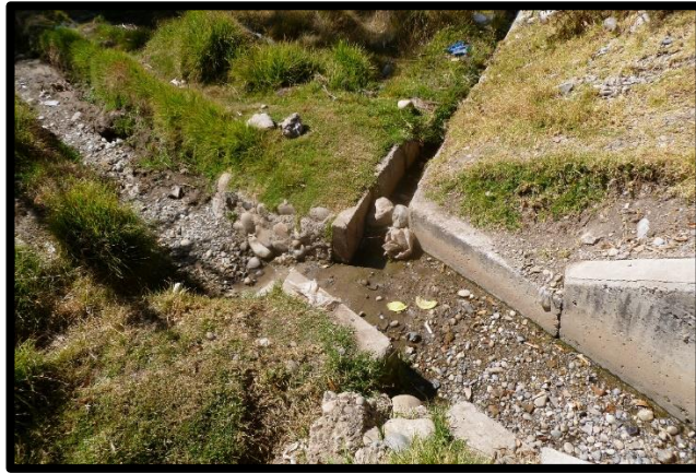
Figura 9. Canal Secundario Interrumpido, por otro Canal no Proyectado Nota. Fuente Elaboración Propia.
