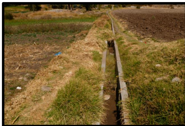
Figura 11. Canales Revestidos Con Malezas En Las Paredes Y En El Fondo Nota. Fuente Elaboración Propia.
