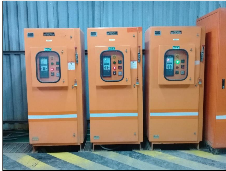
Figura: 08: Montaje Y Conexionado De Tableros arrancadores.
