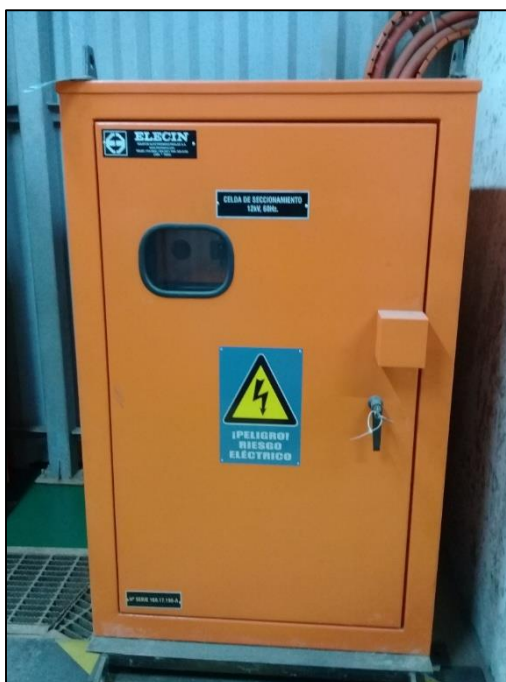
Figura: 05: Celda De Media Tensión De 12 Kv- 200amp.
