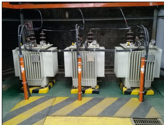
Figura: 06: Banco de transformadores.
