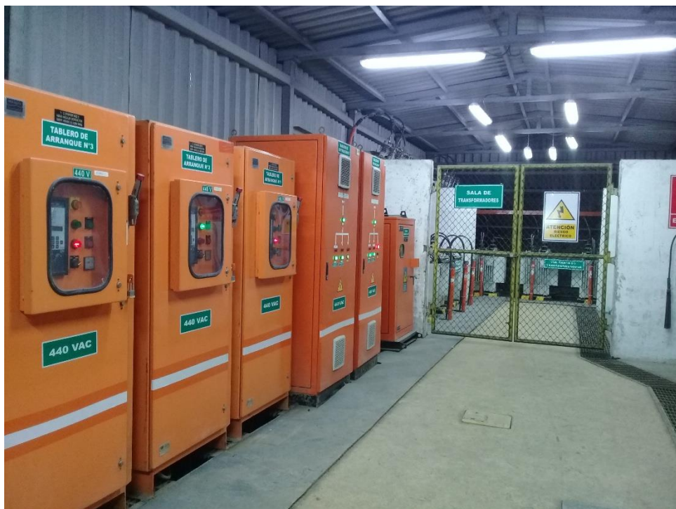
Figura: 12: INSTALACION CCM SSEE 900: Fuente: Elaboración propia
