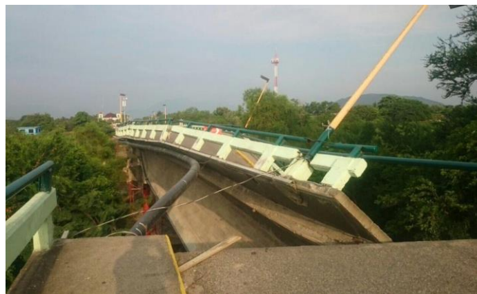
Figura 13. Puente Oaxaca que colapsó por terremoto en México el 2017 Fuente: https://www.eluniversal.com.mx/estados/cae-puente-en-el-istmo-tras-sismo-en-oaxaca-tenia-danos-de-temblor-anterior
