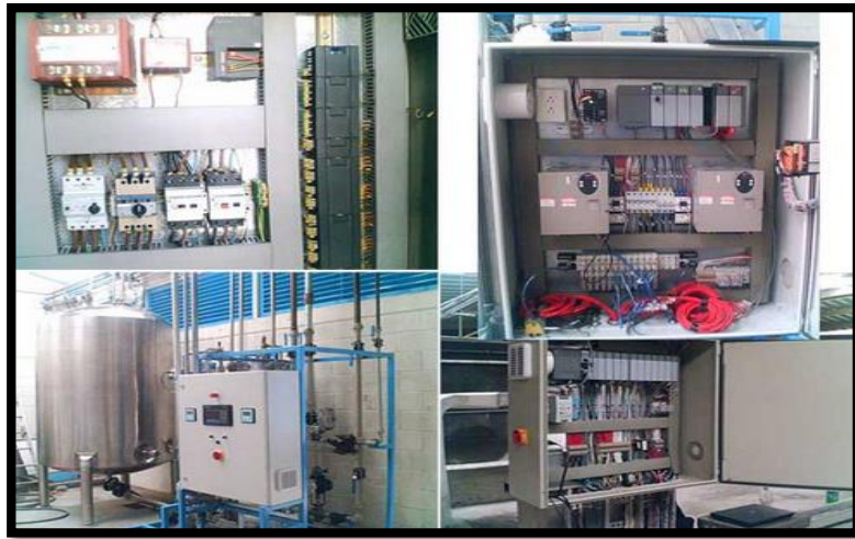
Figura 8: Cableado físico del PLC asociado a contactores, interruptores.
