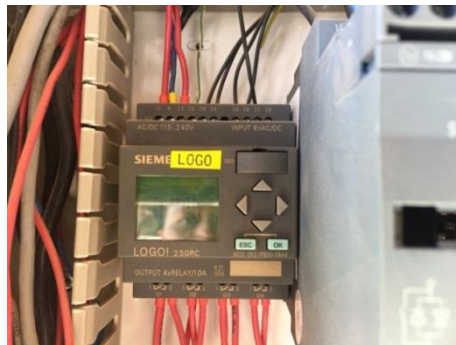
Figura 21: Modulo logo instalado en tablero. (Fuente: Propia)
