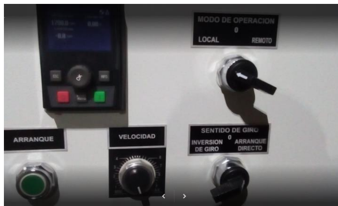
Figura 23: Tablero de control. (Fuente: Propia)
