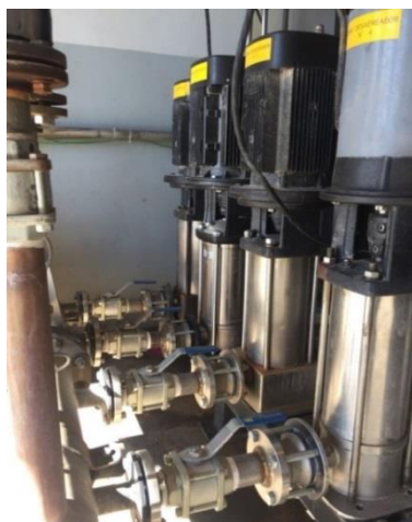
Figura 22: Bombas de alimentación. (Fuente: Propia)
