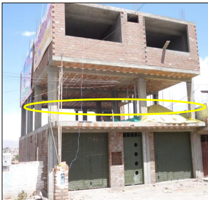
Figura 1. Irregularidad por Piso Blando (Jr. Santa Rosa Cd 13– El Tambo)
