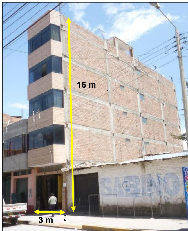
Figura 3. Irregularidad en altura, 16/3 > 4 (Jr. Arequipa Cd 13 – Huancayo)
