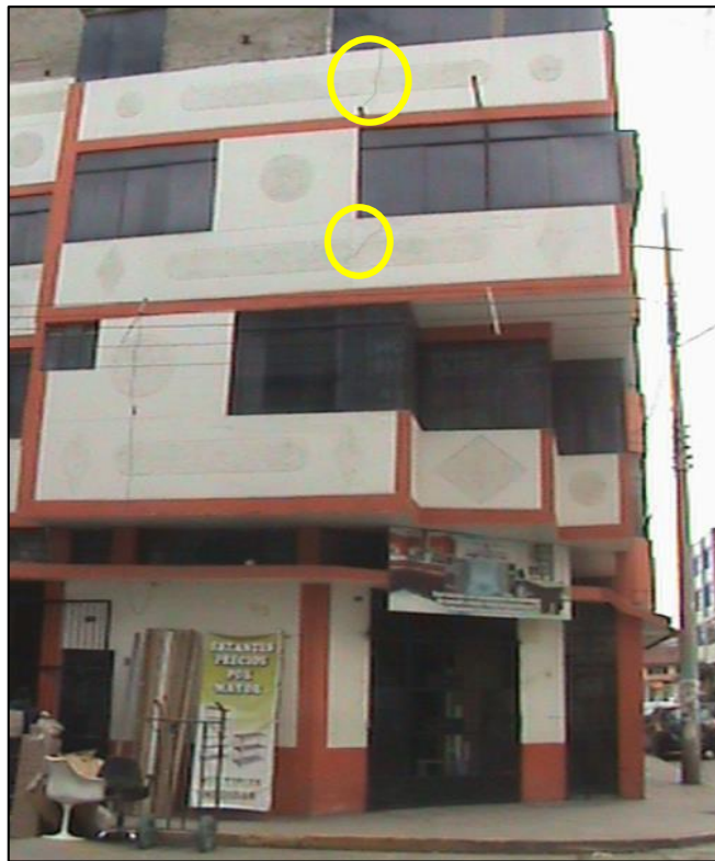
Figura 7. Agrietamiento en tabique por deflexión del volado (Esquina Jr. Tarapacá y Jr. Libertad)
