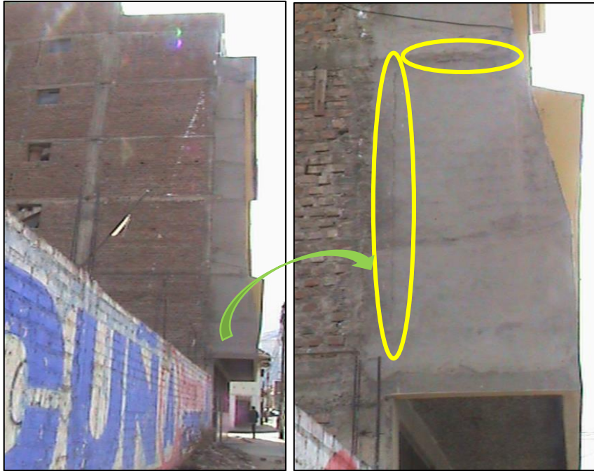
Figura 6. Agrietamiento en muro por deflexión del volado (Esquina Jr. Huánuco y Jr. Moquegua)
