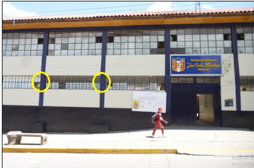
Figura 4. Presencia de columna corta (Huancayo)
