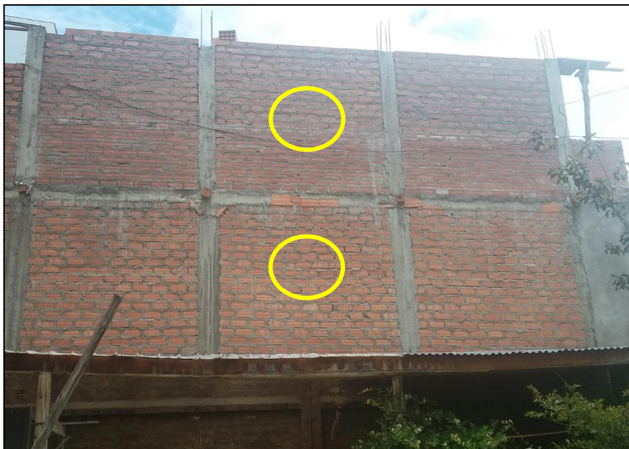
Figura 5. Uso inadecuado de materiales de construcción, ladrillo pandereta en muro portante (Jr. A.A. Cáceres Cd 02)
