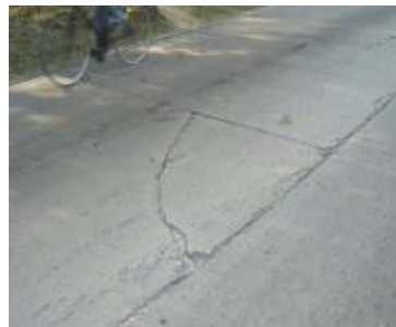
Figura 7: Fisura de esquina
