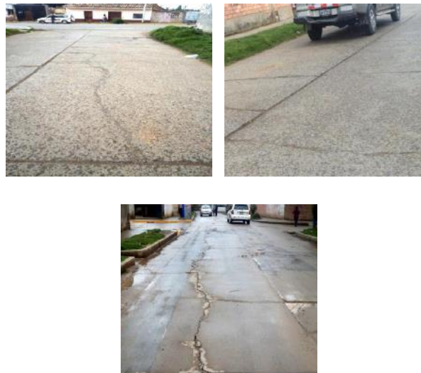
Figura 9: Fisura lineal – baja, media y alta.
