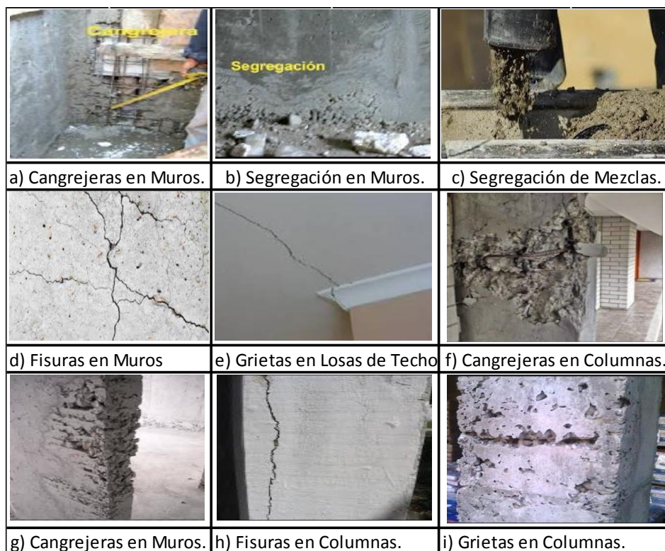
Figura 1. Problemas que se presentan en el concreto autocompactante.
