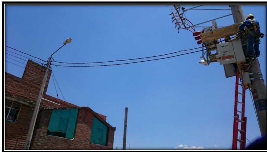
Figura 10: Subestación de distribución Fuente: Elaboración propia
