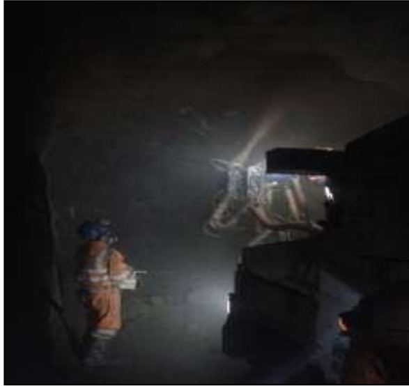
Figura 28. Lanzado de concreto con el Robot Alpha20, perteneciente a E.E. Robocon Fuente: fotografía tomada por el autor
