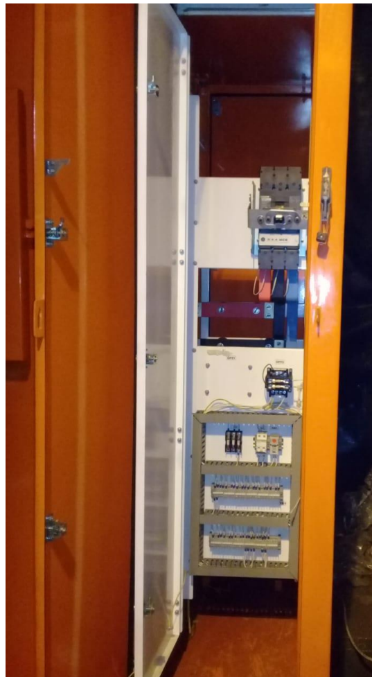
Fotografía N° 04: Interruptor principal banco de condensadores Fuente: Compañía Minera Volcán S.A.A.
