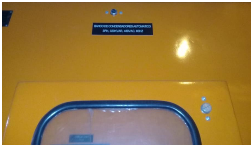
Fotografía N° 02: Capacidad de banco de condensadores Fuente: Compañía Minera Volcán S.A.A.
