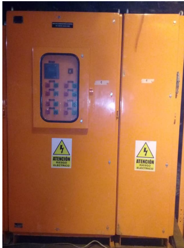
Fotografía N° 01: Banco de condensadores sistema de bombeo Fuente: Compañía Minera Volcán S.A.A.
