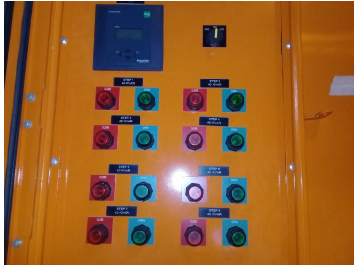
Fotografía N° 03: Sistema de control de banco de condensadores Fuente: Compañía Minera Volcán S.A.A.
