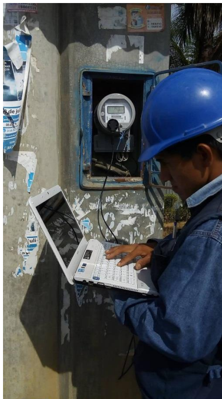
Fotografía N° 04 Técnico de la empresa, descargando información del medidor
