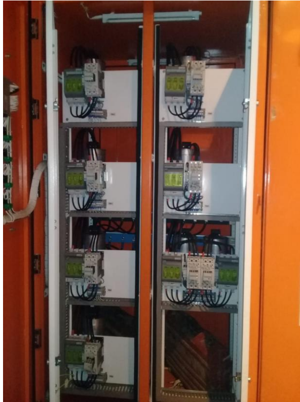
Fotografía N° 05: Banco de condensadores ubicados por pasos Fuente: Compañía Minera Volcán S.A.A.
