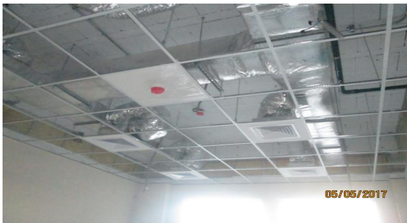
Imagen 172 : Ductos del sistema de climatización.
