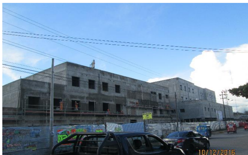
Imagen 111 : Tarrajeo – fachada sector 02 y 03.
