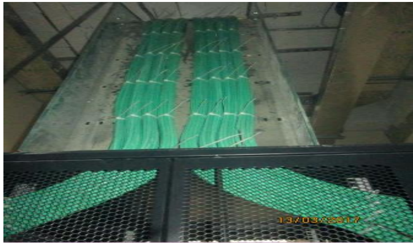
Imagen 215 . Elementos – Gabinete de comunicaciones.
