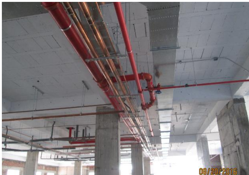
Imagen 183 : Redes de agua de contraincendios y agua caliente sector 04, nivel 01.
