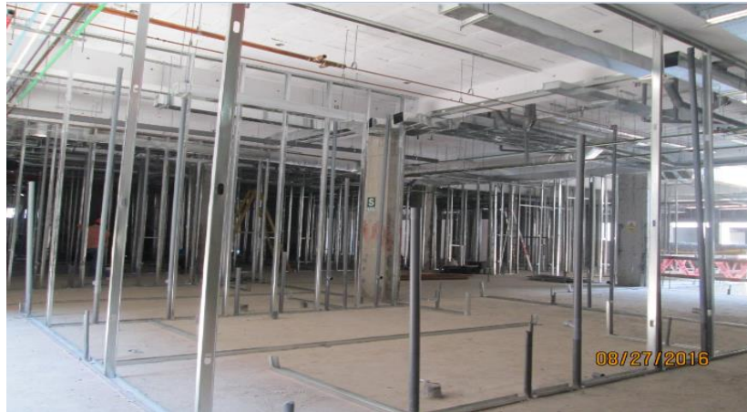
Imagen 134 : Trabajos de instalación de perfilería para tabiquería seca – Drywal. Primer nivel, sector 04.
