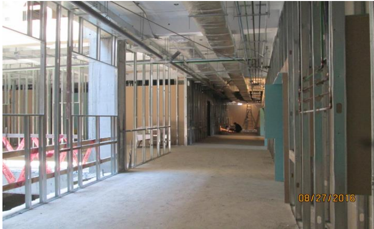
Imagen 131 : Trabajos de instalación de perfilería concluidos para instalación tabiquería seca – Drywal Tercer nivel, sector 03.
