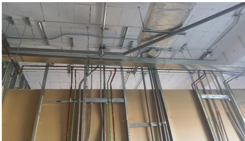
Imagen 133 : Acumulación de instalaciones en un ambiente
