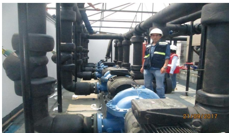
Imagen 176 : Equipos Paquete – azotea sector 04.
