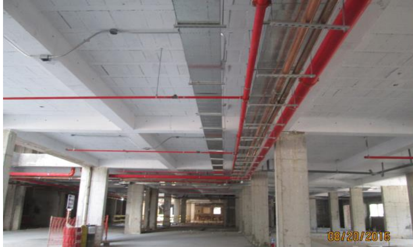
Imagen 185 : Redes de agua de contraincendios, agua helada y agua caliente sector 02, nivel 03.
