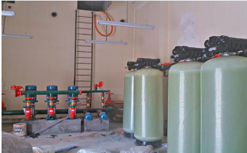
Imagen 199 : Cuarto de Bombas, cisterna.
