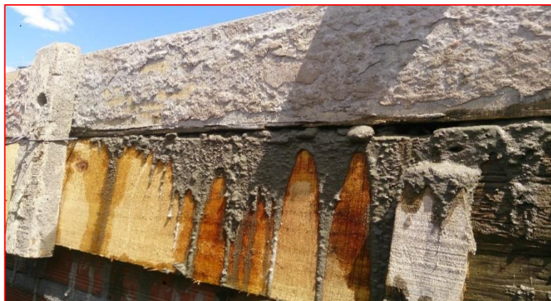
Figura 102: Inadecuado encofrado; desperdicio de mortero a causa de la falta de hermeticidad
