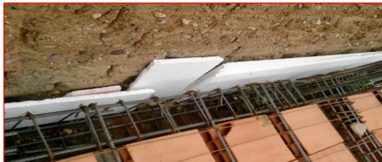
Figura 106: Mala práctica, colocado de tecnopor sin un tipo de fijación
