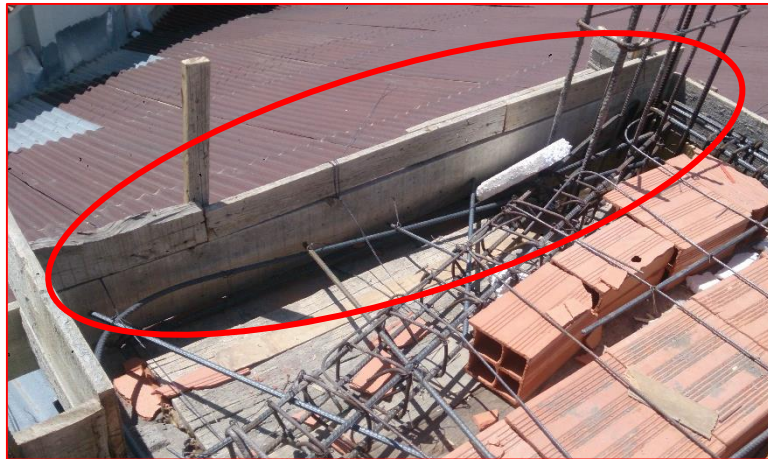
Figura 101: Maderas en mal estado, alabeadas con presencia de rajaduras
