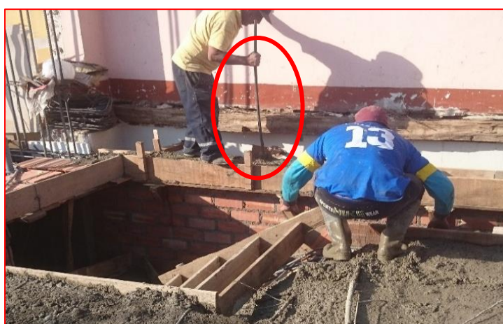
Figura 85: Chuceo ejecutado con de tubo de luz (procedimiento inadecuado)
