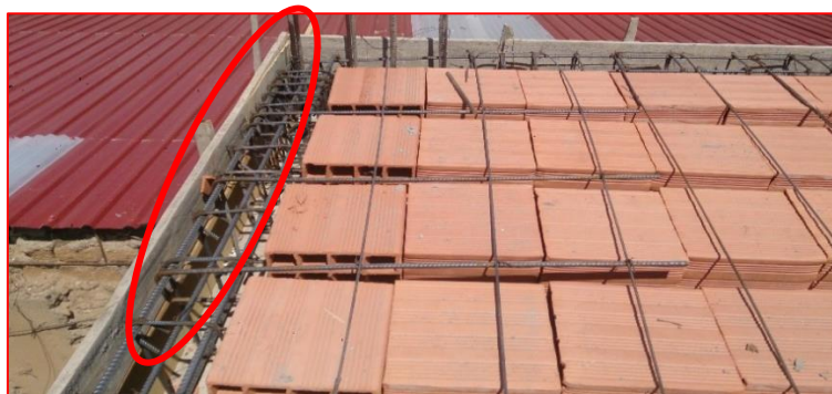
Figura 98: Presencia de aberturas en las juntas de madera entre el friso y el fondo de losa
