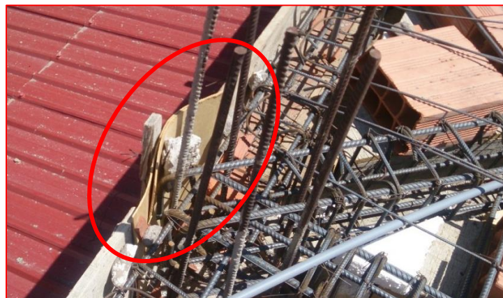
Figura 99: Mala práctica: uso de triplay con e= 10mm, sin una fijación adecuada
