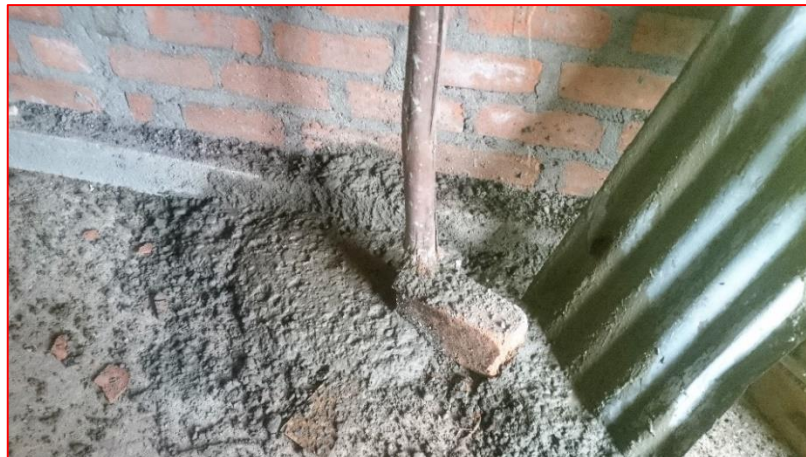
Figura 108: Apuntalamiento inadecuado, uso de ladrillo mal colocado para alcanzar la altura
