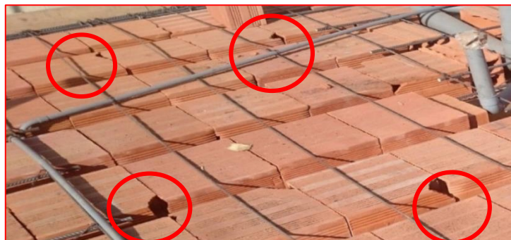
Figura 110: Bloquetas rotas a causa de la falta de tablas por donde pasan los buguis
