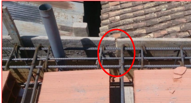
Figura 97: Presencia de aberturas en las juntas de los frisos
