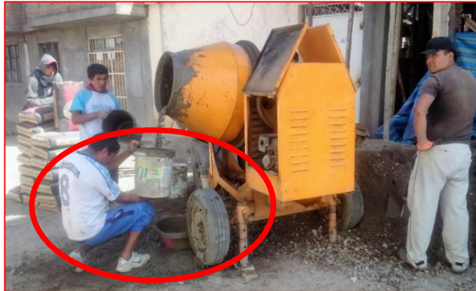
Figura 81: Gran cantidad de desperdicio en el traspaso de mezcla del trompo al balde de aceite
