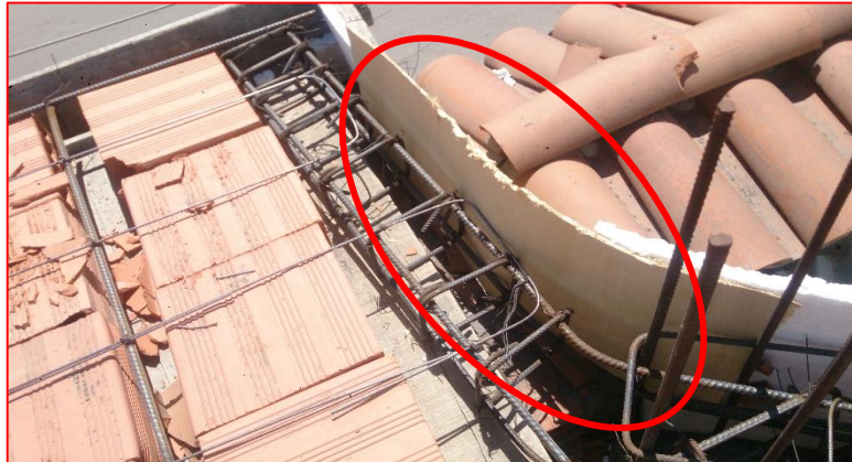
Figura 100: Encofrado inadecuado en tramos de forma curvos sin respetar recubrimientos mínimos
