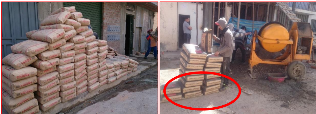
Figura 89: Bolsas de cemento en contacto con el suelo
