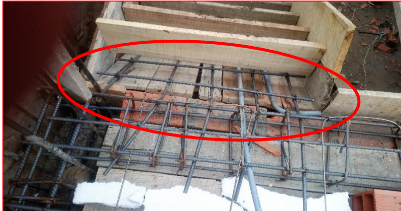
Figura 103: Maderas en mal estado, alabeadas con presencia de rajaduras
