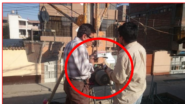
Figura 82: Personal no calificado tratando de solucionar la falla técnica del winche
