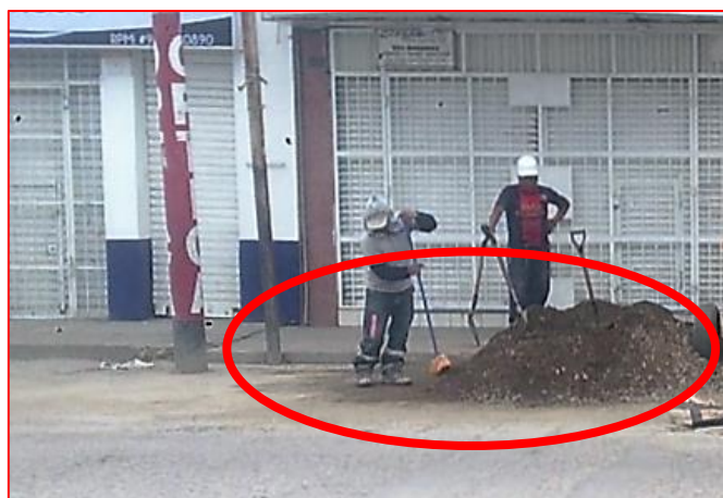
Figura 92: Mala práctica: Hormigón siendo combinado con el uso de escoba, con tierra y polvo
