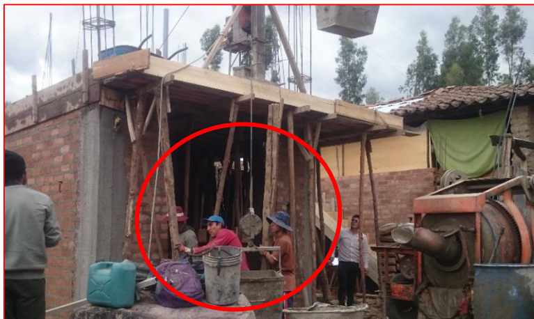
Figura 109: El apuntalamiento inadecuado genero la inestabilidad del volado de la vivienda
