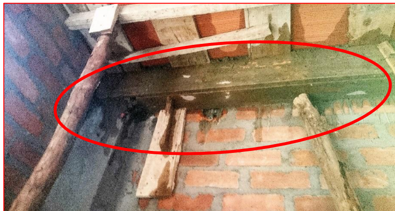
Figura 105: Gran cantidad de desperdicio de mortero a causa de que el encofrado no es hermético
