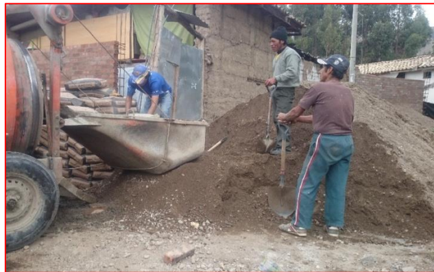
Figura 91: Mala práctica: Hormigón sobre la vía, expuesto a contaminarse.
