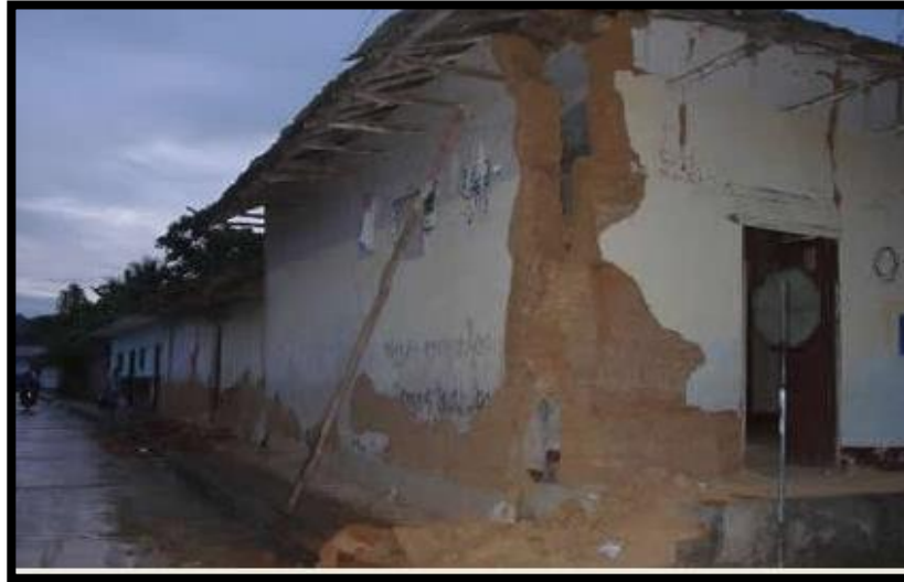
Figura 1: Edificación de adobe, colapsada en el evento de sismo de Arequipa.
