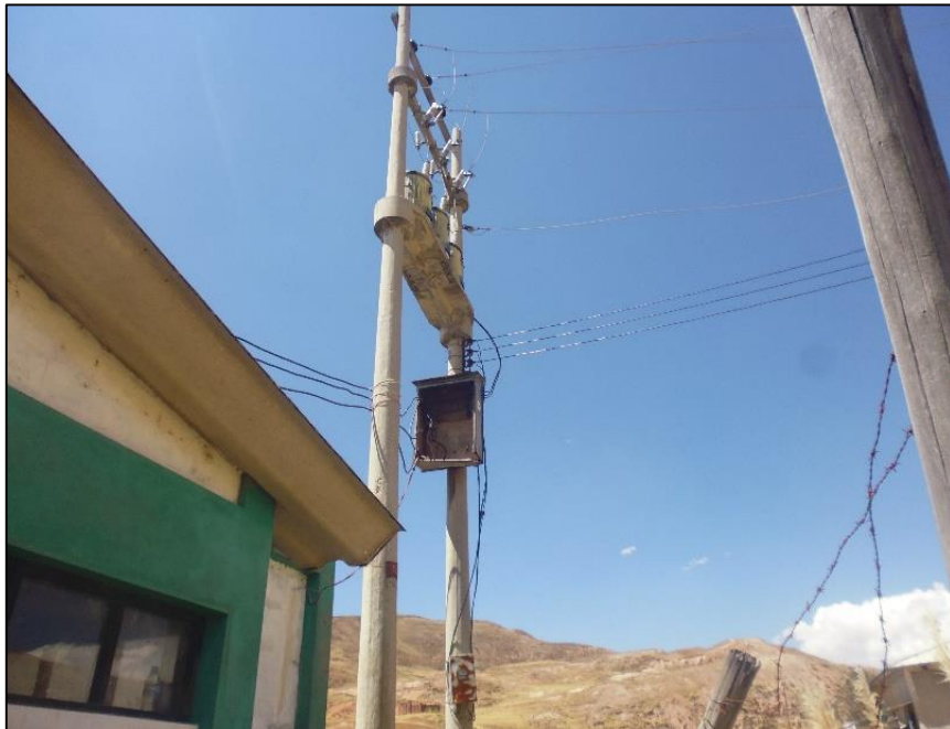
Figura: 5 Subestación trifásica Fuente: Elaboración propia
