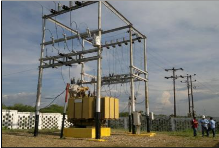
Figura: 4 Alimentador de energía eléctrica A4332 Fuente: Elaboración propia
