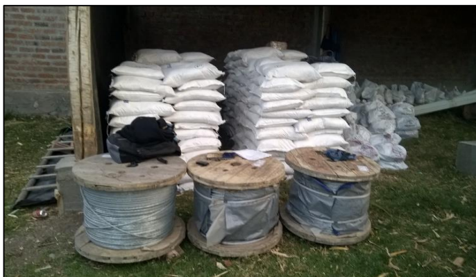
Figura: 13 Almacenamiento de Conductor de AAAC de 25 mm 2 .
