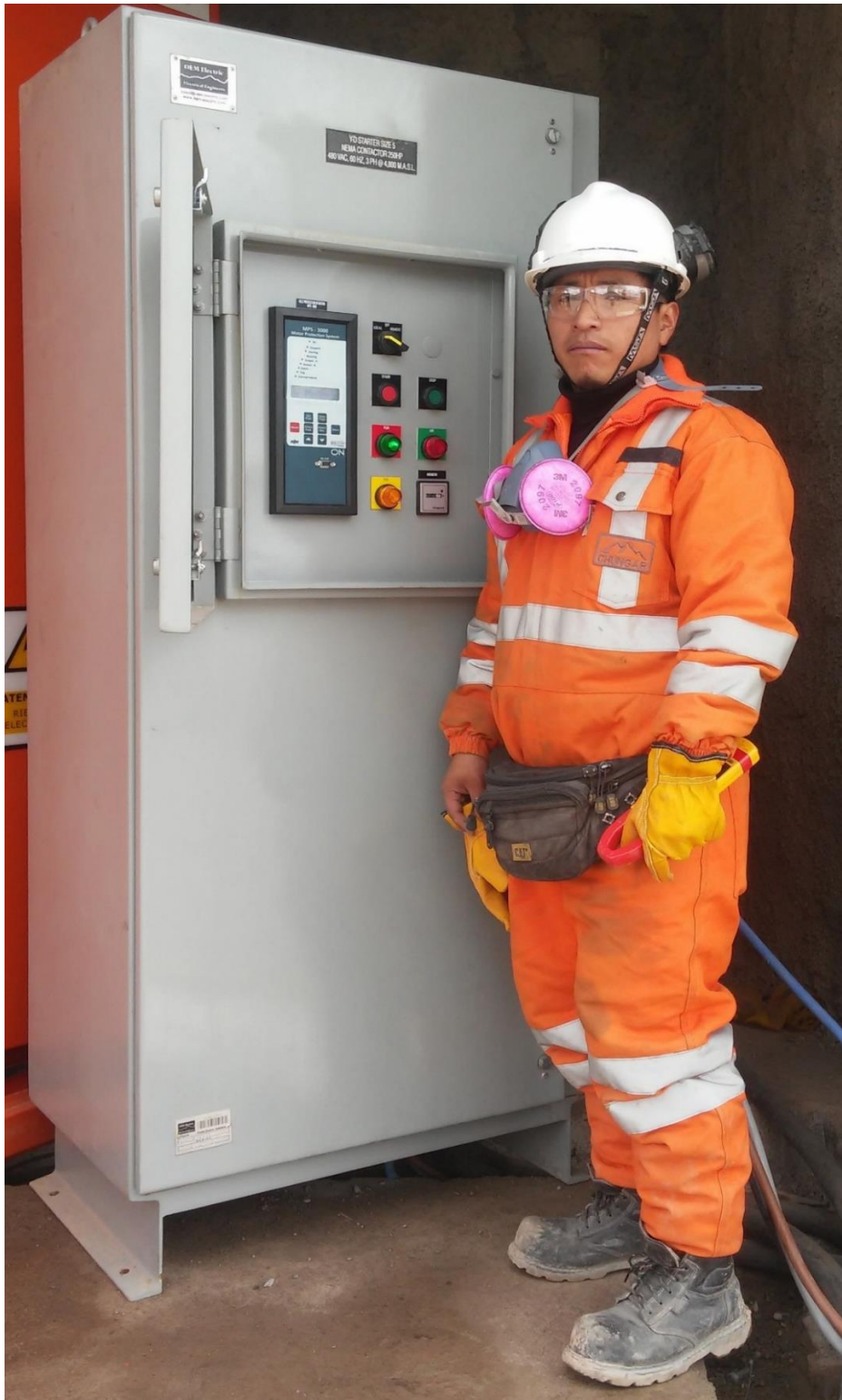
Fotografía 4: Tablero convencional actual de 250HP Estrella triangulo
