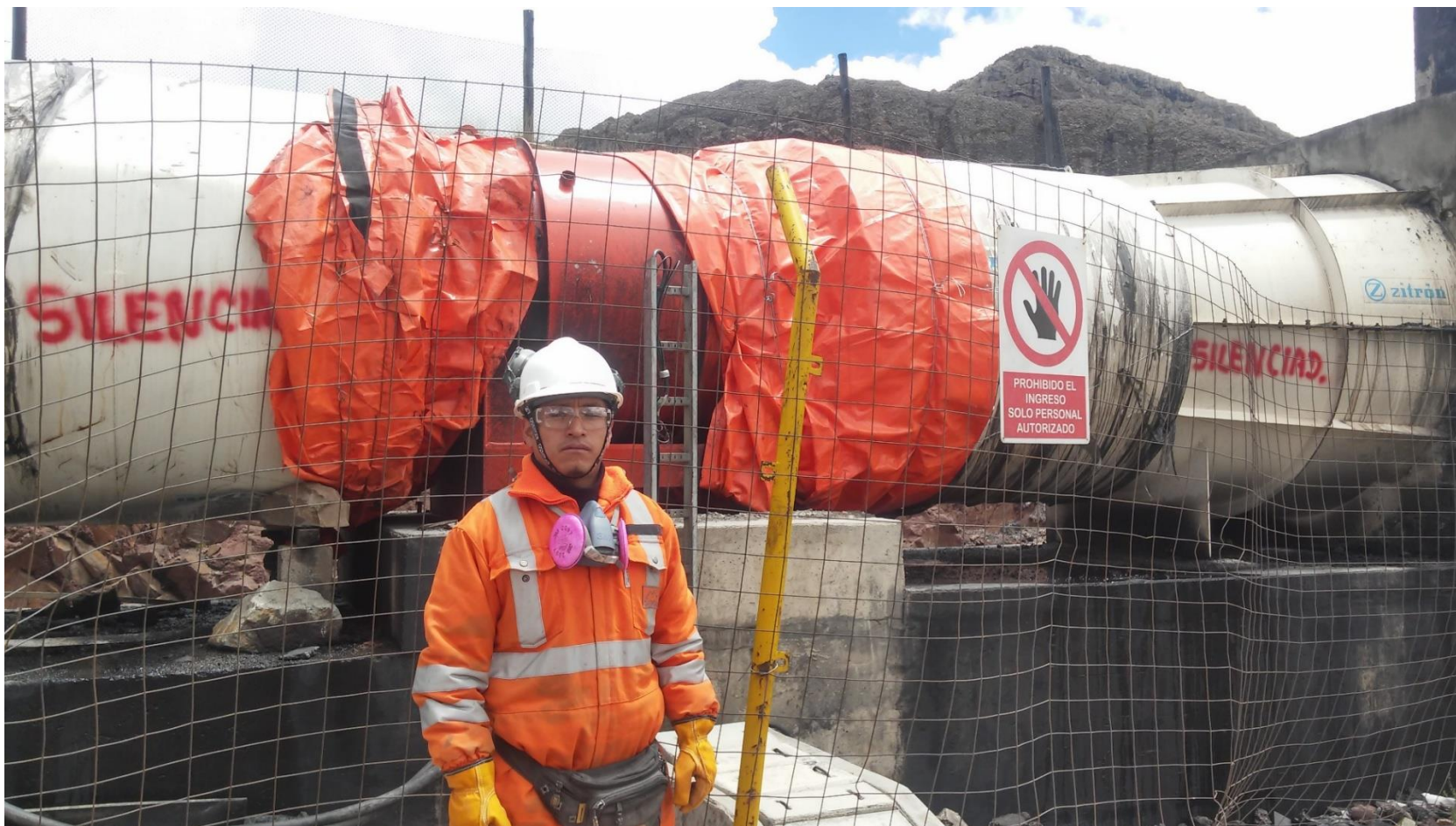
Fotografía 7: Vista panorámica de ubicación del ventilador 250HP
