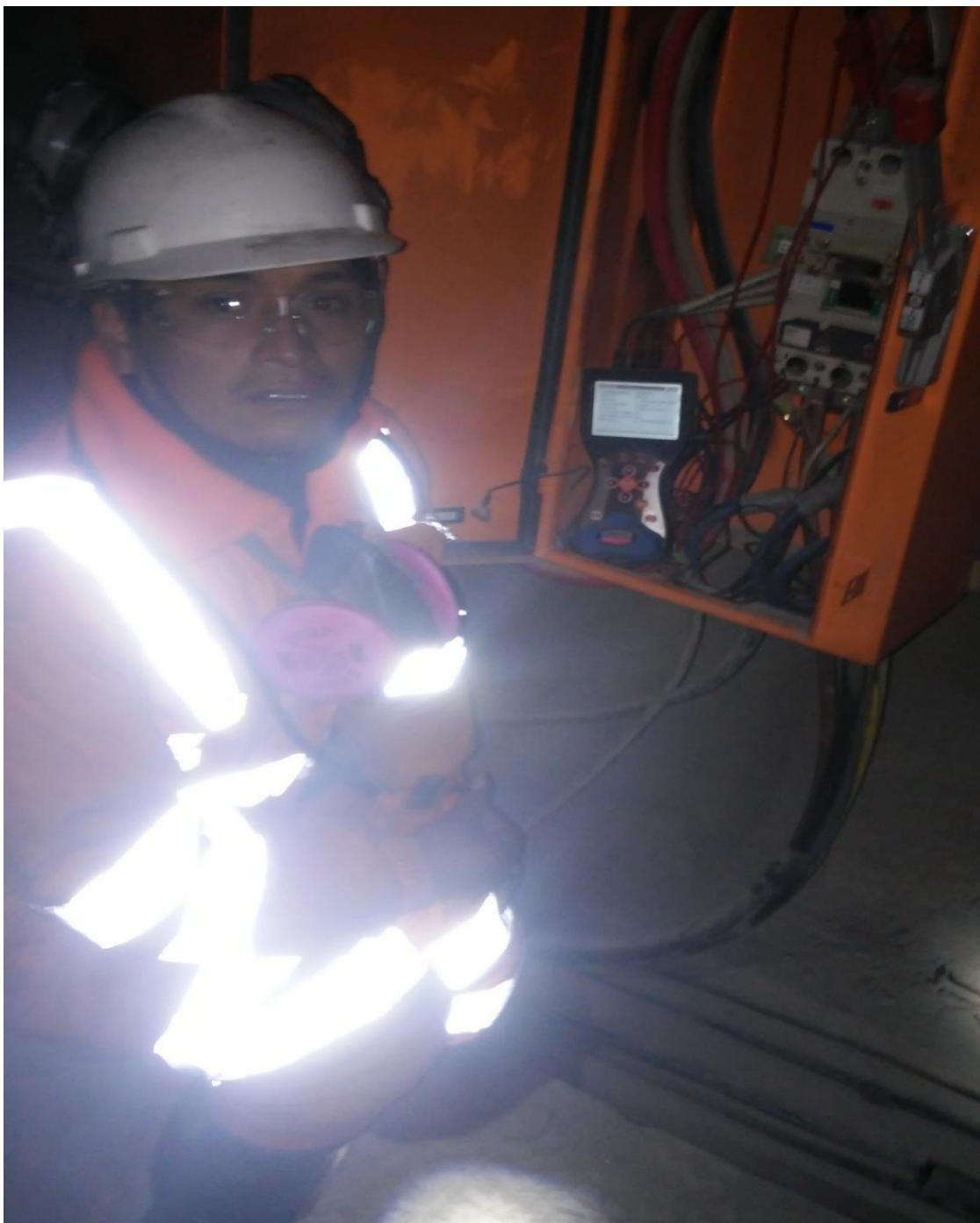
Fotografía 5: Instalando analizador de redes en interruptor principal del ventilador de 250HP Fuente: Compañía minera CHUNGAR S.A.C
