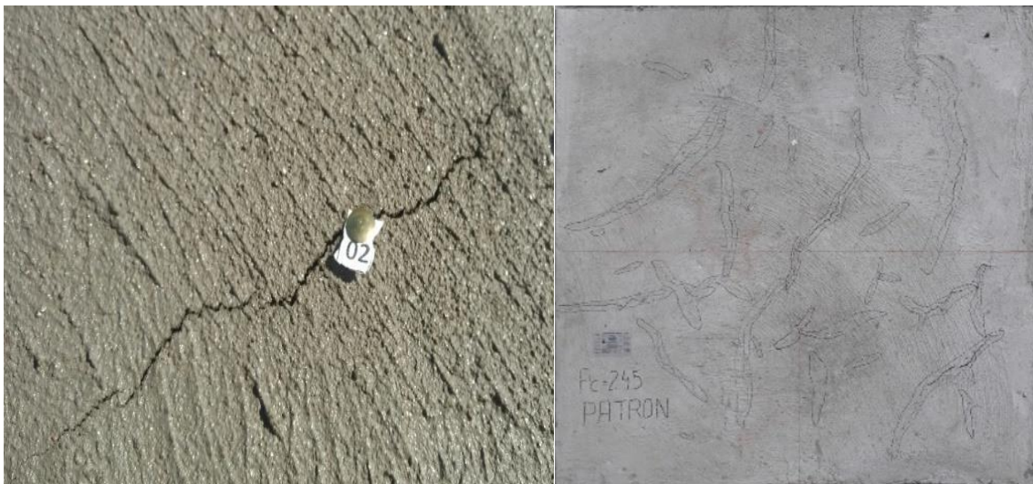
Figura 2. 8 Fisura generada por retracción plástica en losa aligerada f'c=245 kg/cm 2 .
