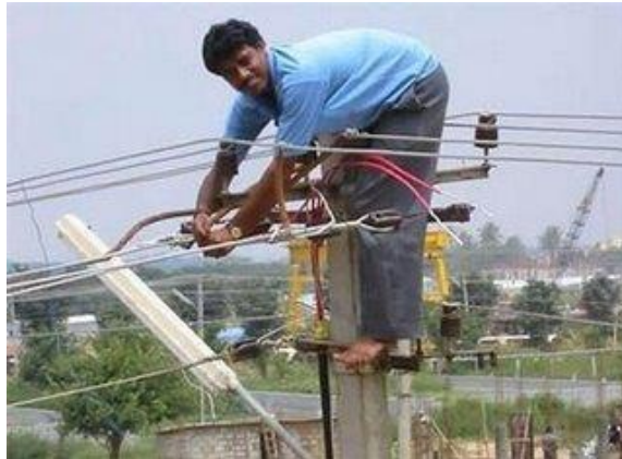
Figura N° 3. Manipulación o Laborar sin implementos de seguridad.
