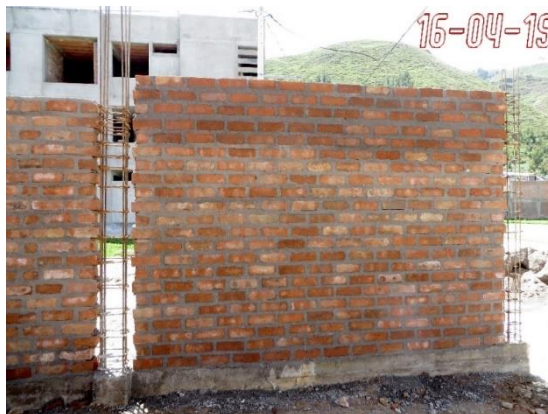
Figura 29. Muro de albañilería confinada, conexión dentada. Sin embargo, nótese el uso de unidades artesanales
