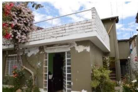
Figura 79. Edificación de albañilería confinada (N° 006) sin elementos de confinamiento, presenta fallas en los muros
