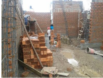
Figura 176. Adecuado uso de materiales en una edificación de albañilería confinada, ladrillos con 30% de vacíos
