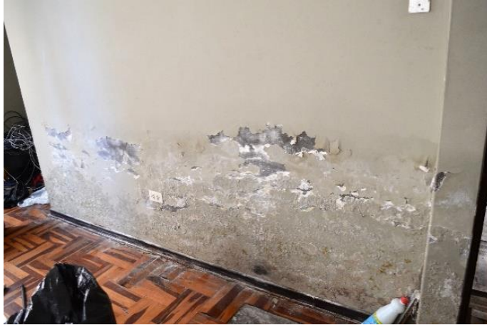
Figura 189. Edificación de albañilería confinada donde los muros se han visto afectados por la ruptura de una tubería aparentemente en la losa del baño contiguo
