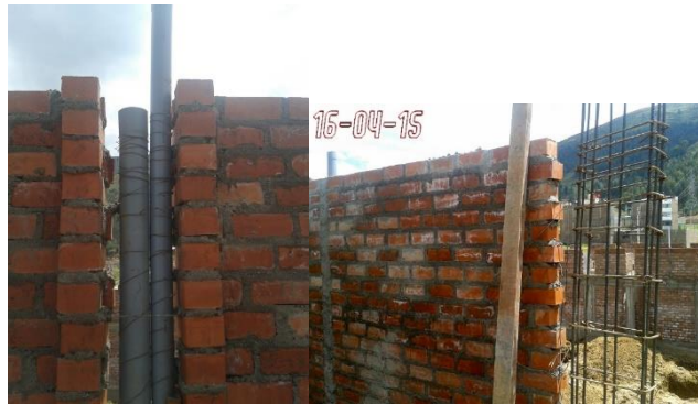
Figura 30. Dientes de los muros de albañilería y columneta para albergar las tuberías, nótese el zunchado
