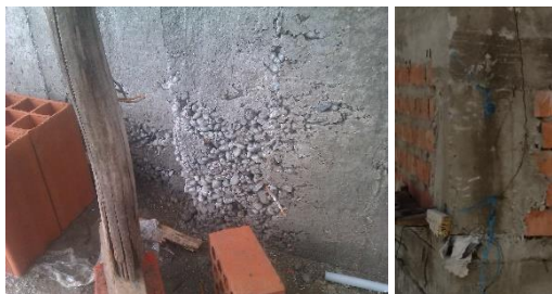
Figura 64. Edificaciones de albañilería confinada con cangrejas en las columnas de confinamiento
