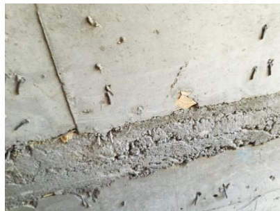
Figura 72. Edificación de albañilería confinada analizada con presencia de cangrejera en la vigueta de la losa aligerada
