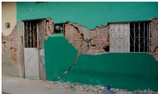
Figura 84. Fallas en los muros por ausencia de elementos de confinamiento 39
