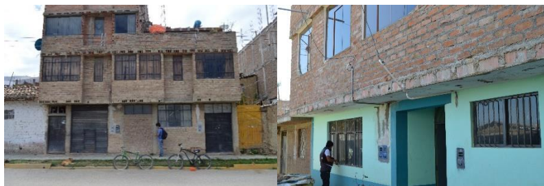
Figura 66. Ejemplo de edificaciones de albañilería confinada analizadas sin vigas de confinamiento, sino solo con losas
