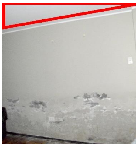
Figura 190. Muro afectado un muro portante, es necesario estabilizar la zona de intervención. La propuesta es apuntalar el área tributaria con madera de eucalipto
