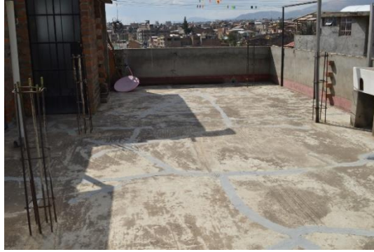
Figura 194. Losa tras el aplicado de Sikaflex 11FC+. Nótese que antes de la intervención se tuvo que identificar y detener su origen, así como tener precauciones con las pendientes
