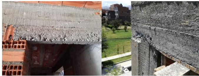
Figura 68. Edificaciones analizadas de albañilería confinada que presentaban cangrejas en las vigas
