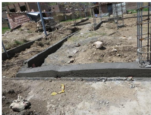
Figura 26. Autoconstrucción de cimentación, nótese el sobrecimiento desnivelado y sin rayar para el asentado de ladrillos
