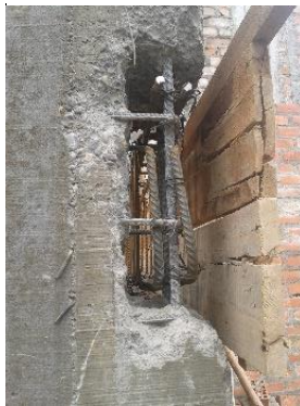
Figura 177. Ejemplos de la construcción con mano de obra no calificada, picado de columna
