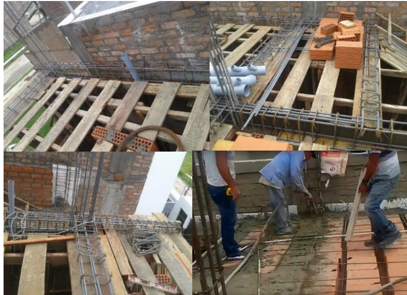
Figura 33. Proceso constructivo de vigas de confinamiento y losa, encofrado de losa, armado de vigas, losa y vaciado
