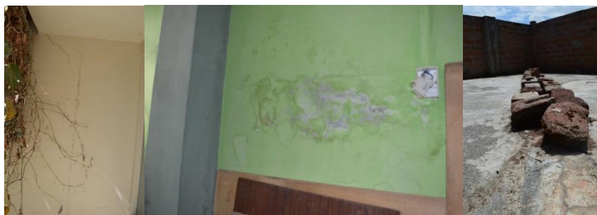
Figura 87. Defectos por falta de mantenimiento: 1) fisuración en los muros de albañilería. 2) Humedad en las paredes. 3) Filtración en losas del último nivel
