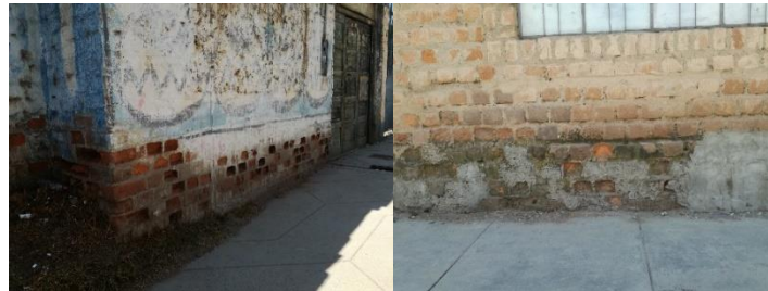
Figura 62. Muros con eflorescencia en las unidades artesanales
