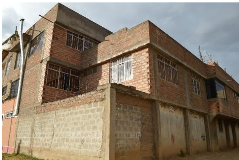
Figura 186. Edificación de albañilería confinada que basa su desempeño estructural en unidades pandereta explícitamente prohibidas para este fin, se ubica en el distrito de Huancayo
