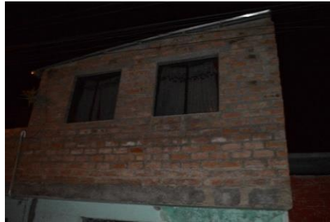
Figura 80. Muro mayor a tres metros sin elementos de confinamiento
