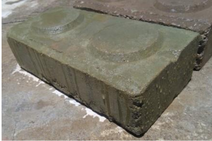
Fotografía 50: BTC impermeabilizado con sellador Chema después de precipitación
