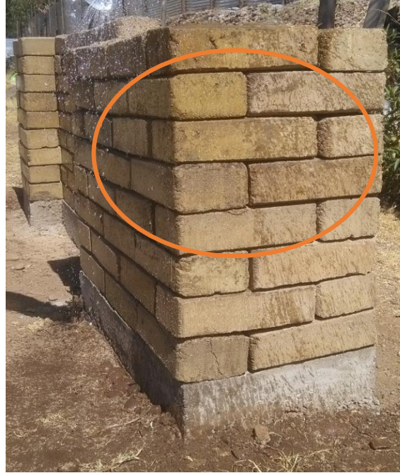
Figura 22: Diferencia del muro con y sin impermeabilizante después de simulación de precipitaciones
