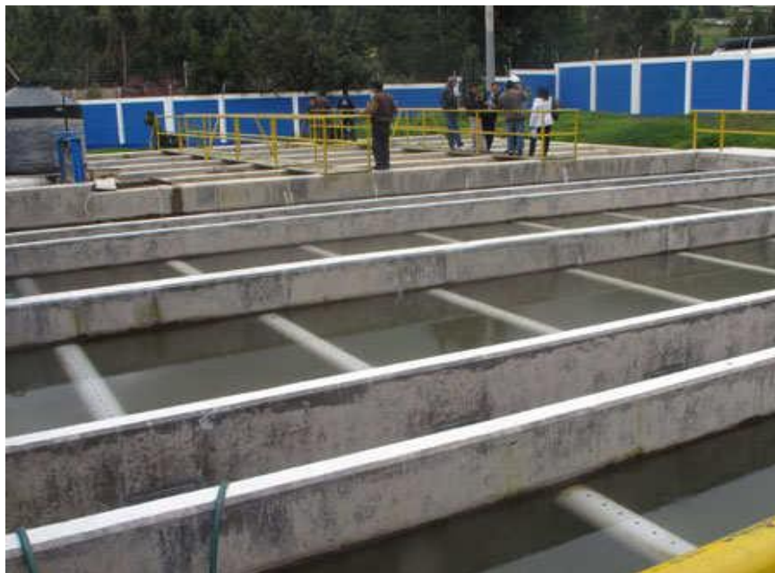
Figura 8: Planta de tratamiento de agua de Vilcacoto.
