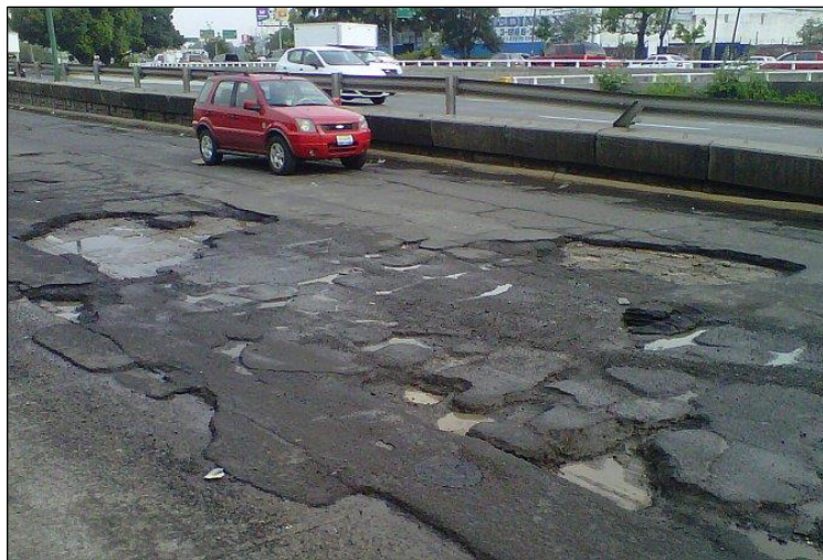
Fotografía N° 02: Pavimentos en mal estado en el Perú
