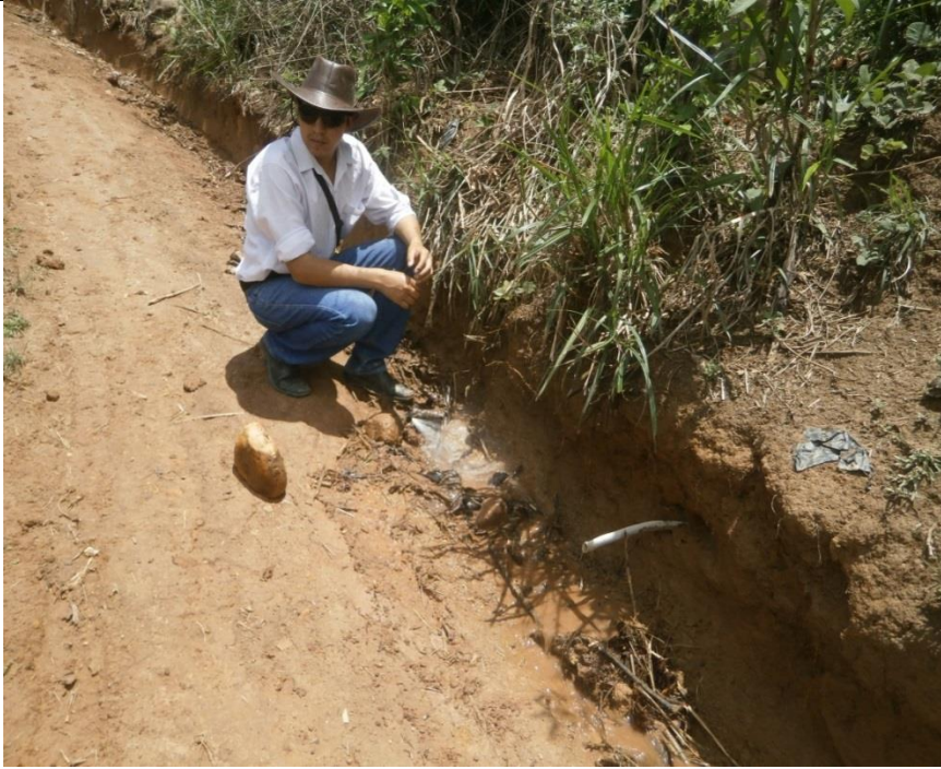
Anexo 31: Red de Distribución Expuesta y quebrada
