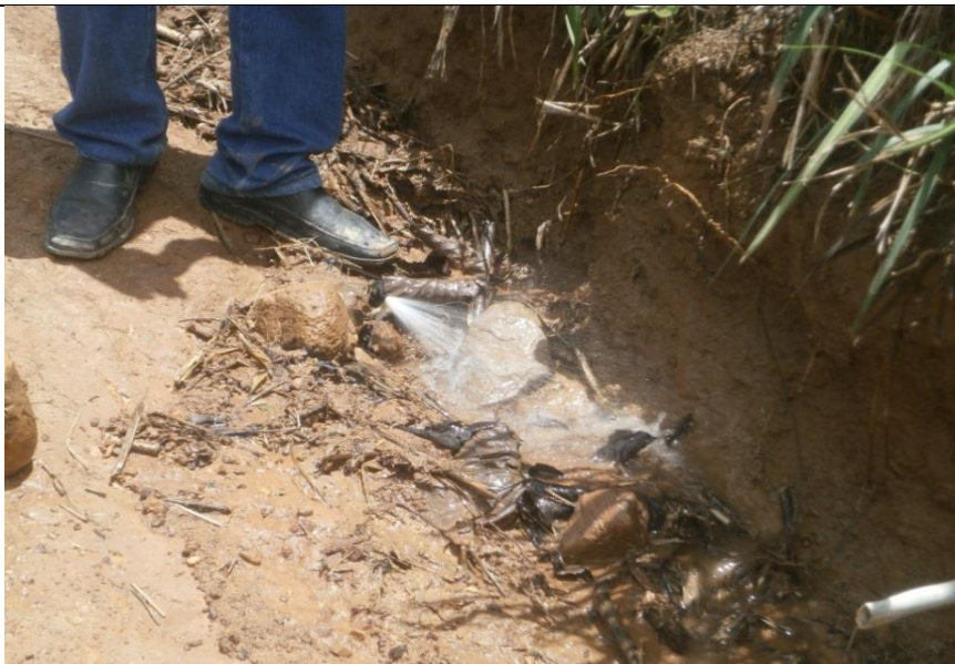
Anexo 32: Red de Distribución Expuesta y quebrada
