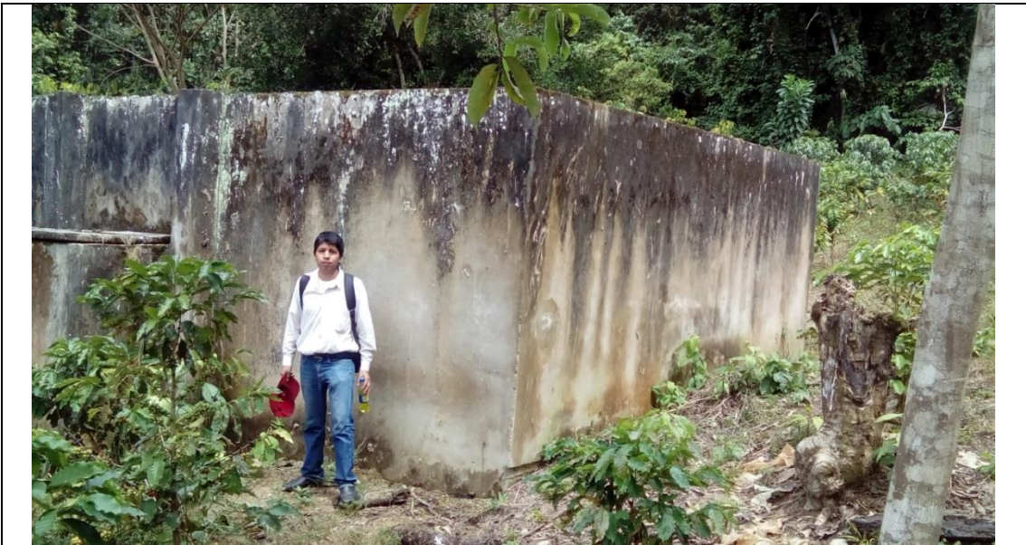
Anexo 34: Filtro Lento Existente
