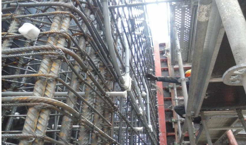
Imagen 46. Instalaciones eléctricas en verticales
