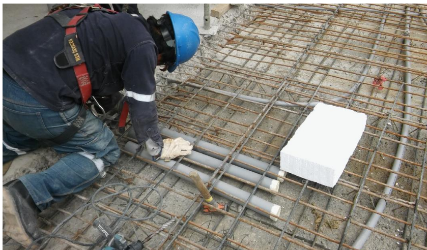
Imagen 45. Instalación sanitaria en losa
