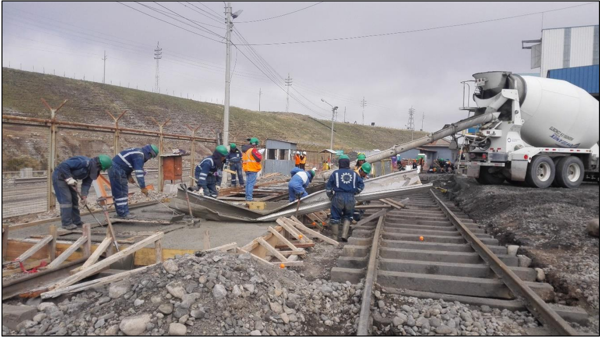
Fotografía 9: Ecosem realiza el vaciado del paso a nivel, mientras FCCA reinstala la vía en el frente 2.
