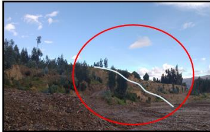
Figura 8: Desprendimiento del talud
