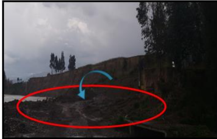
Figura 6: Derrumbe rotacional de la zona de estudio
