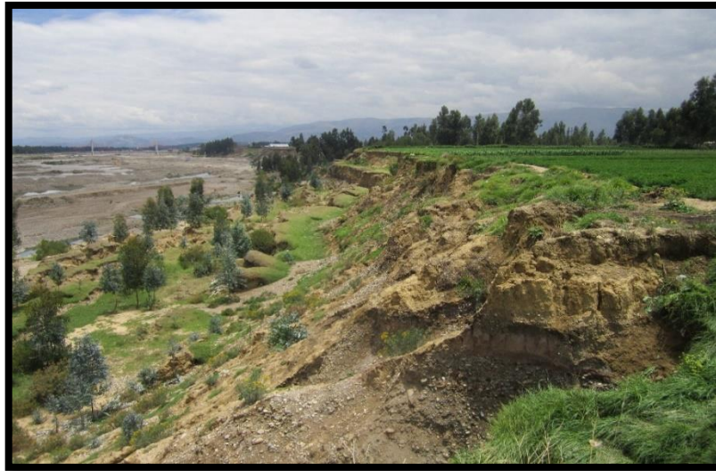
Figura 42: Talud en Falla progresiva 0+260
