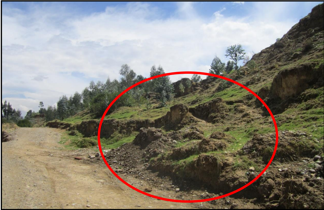
Fotografía 5 Apreciación de desprendimientos ocasionados por la erosión
