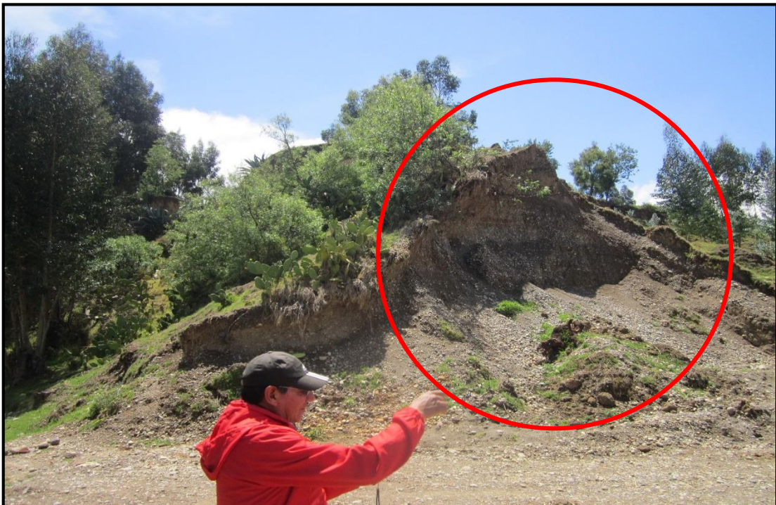
Fotografía 6 Presencia de material suelto entre arenas y arcillas
