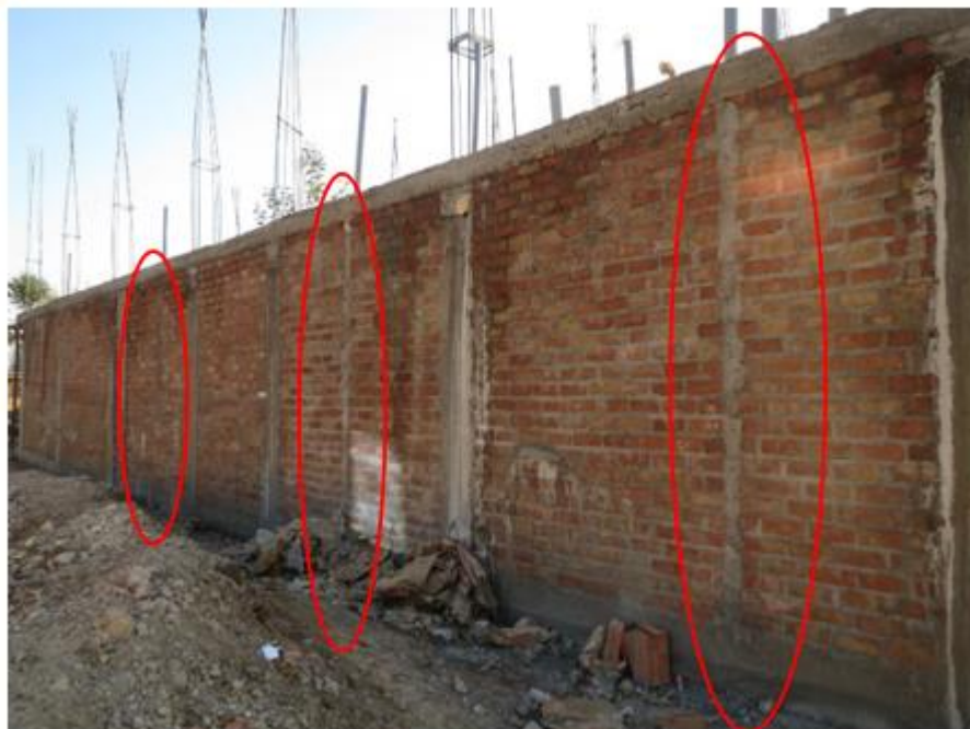
Figura 2: En esta vivienda todos los muros están siendo cortados por el montante de desagüe.
