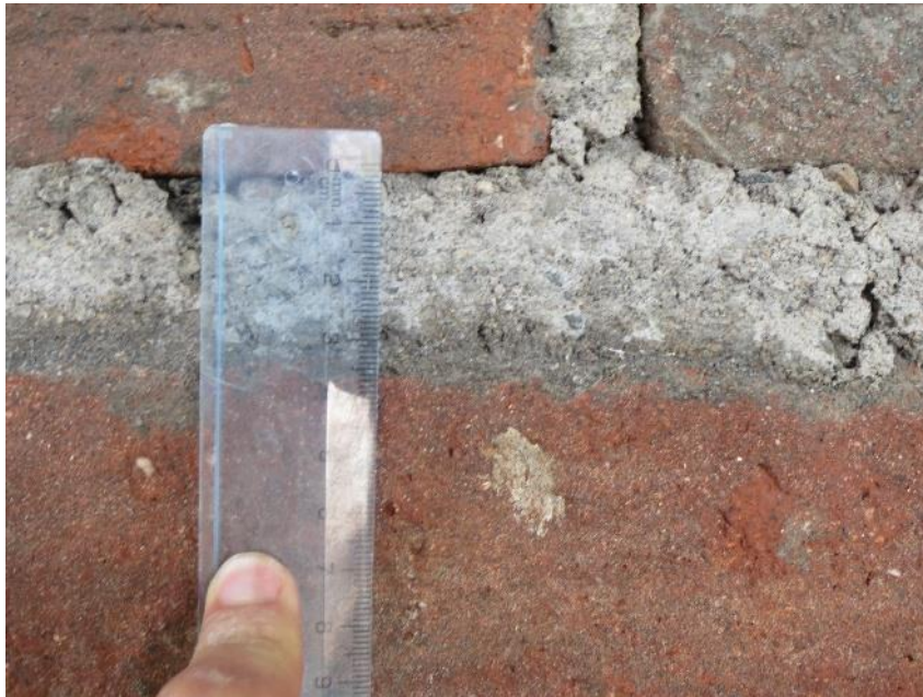
Figura 3: El espesor de juntas, en toda la construcción siempre es mayor 1.5 cm. En esta figura mide más de 3 cm.
